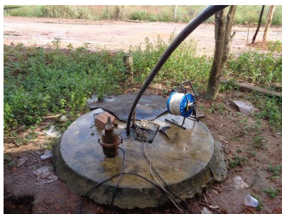
Figura 01. Pontos para monitoramento da qualidade da água sem necessidade de sondagem devido à utilização de poços existentes (PM01, PM03, PM04) na área de influência da UHE Teles Pires.
