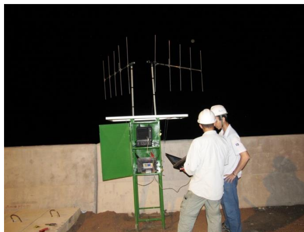
Figura: Instalação de base fixa de radiotelemetria a montante do vertedouro da UHE Teles Pires.
