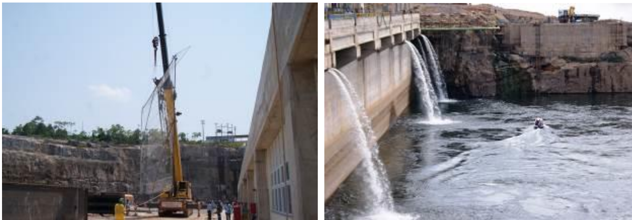
Montagem das grades anticardumes e monitoramento por sonar de cardumes no canal de fuga.
