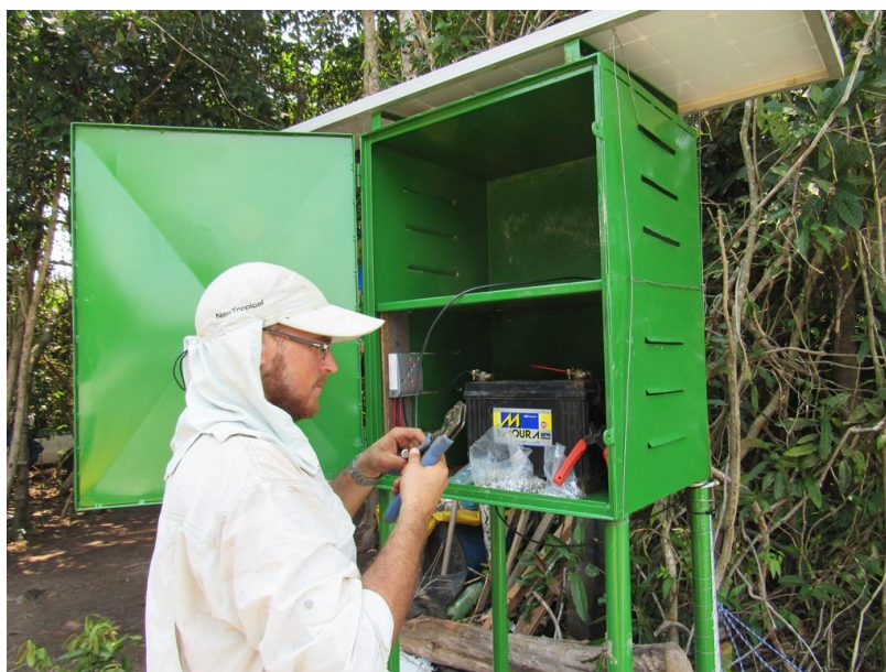
Figura 3 – Instalação elétrica na base fixa de radiotelemetria da Balsa do Cajueiro.
