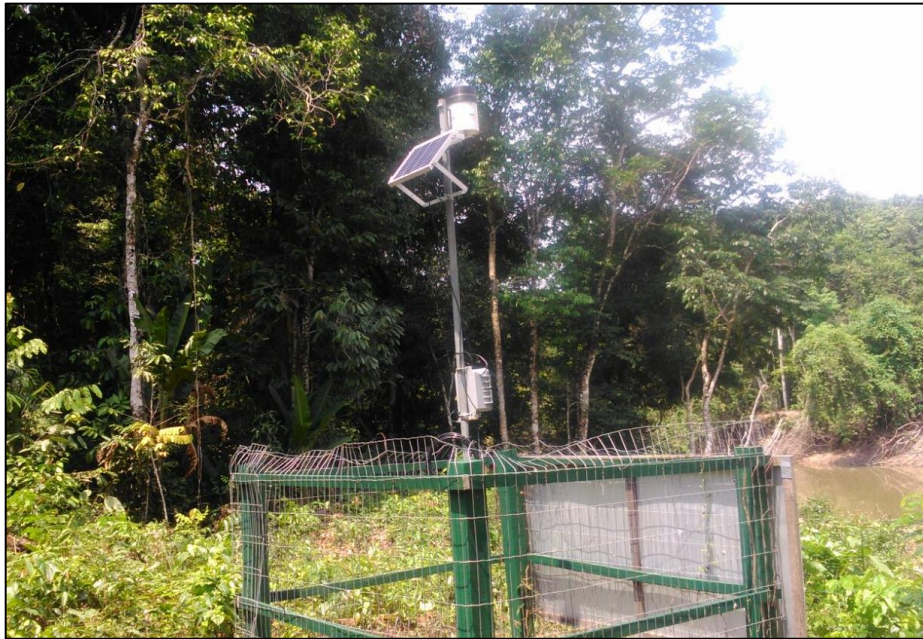
Figura 28. Estação hidrométrica UHE Teles Pires Rio Paranaíta após instalação do novo painel solar em 02/10/2015.
