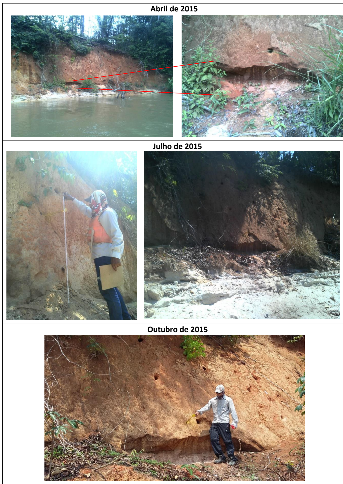
Figura 20. Ponto MD-27 nas campanhas realizadas após o enchimento do reservatório. Na campanha de julho de 2015 verificou-se a ocorrência de pequenos solapamentos no sopé da encosta, já em outubro de 2015 o talude permaneceu estável.
