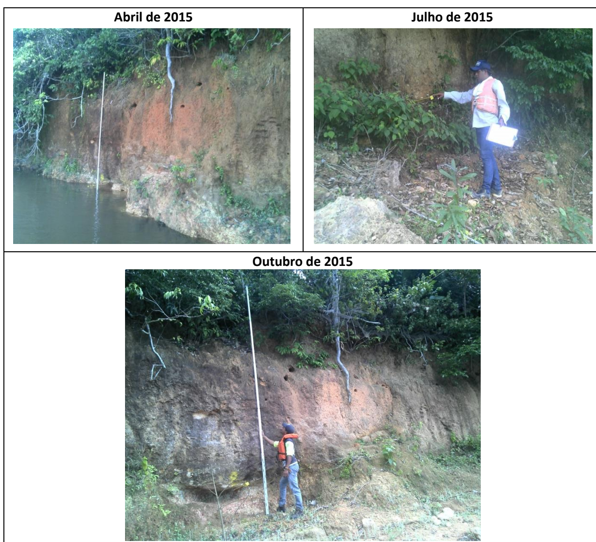
Figura 5. Vista ponto MD-03 nas vistorias de abril, julho e outubro de 2015, após o enchimento do reservatório. Verifica-se que o local está estável em outubro de 2015.
