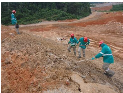
Integrantes realizando o coveamento para posterior plantio no Bota Fora da Margem Direita em Dezembro de 2013.
