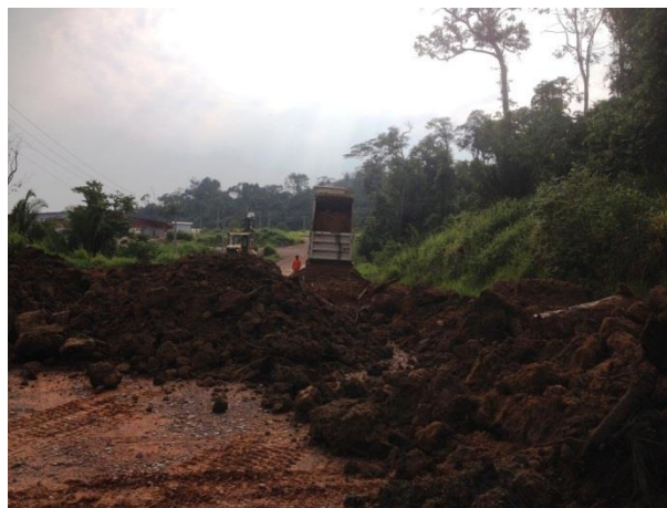
Lançamento de material vegetal no acesso a antiga Rodoviária e escritórios definitivo.
