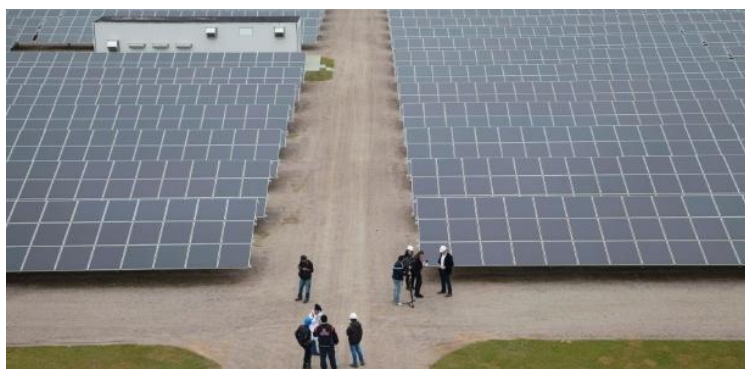
Usina Solar em Tubarão, SC
