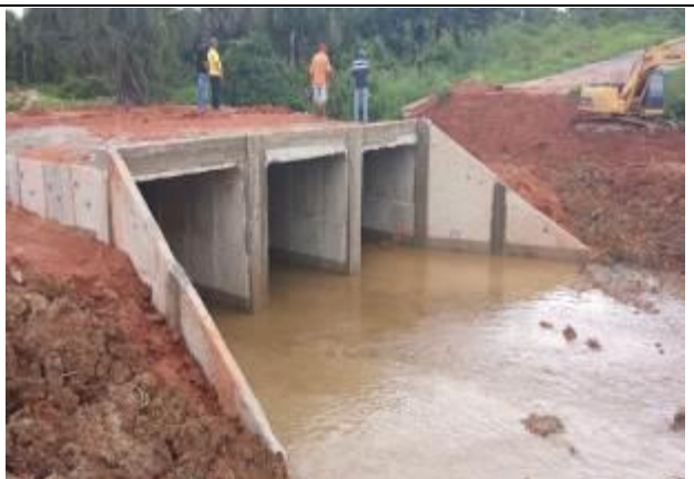
Figura 12: Conclusão do Bueiro Triplo Celular de Concreto Avenida Teles Pires Alta Floresta.
