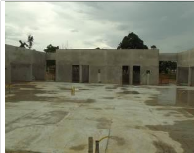
Figura 31: Construção da Rodoviária de Paranaíta.
