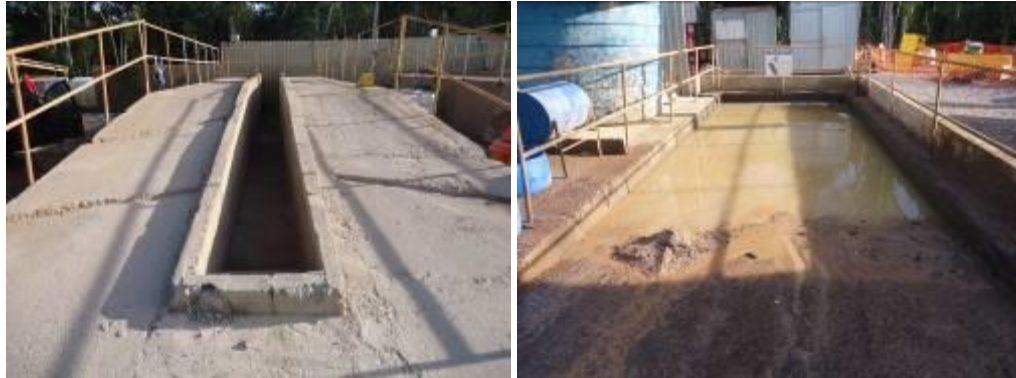
Rampa de lavagem com sistema de drenagem interligado ao tanque de decantação primário ao Sistema SAO.
