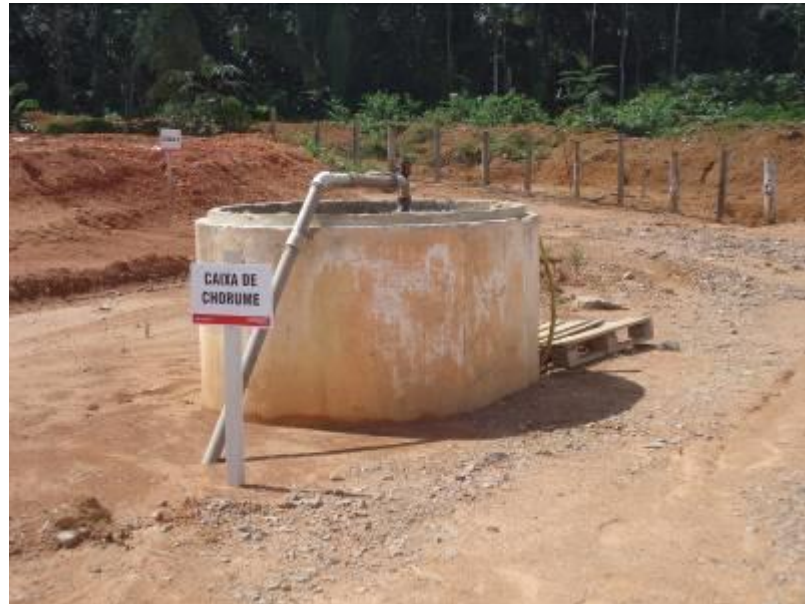
Caixa de chorume CGR- Sistema de bomba automatizado para transporte direto e tratamento na ETE II
