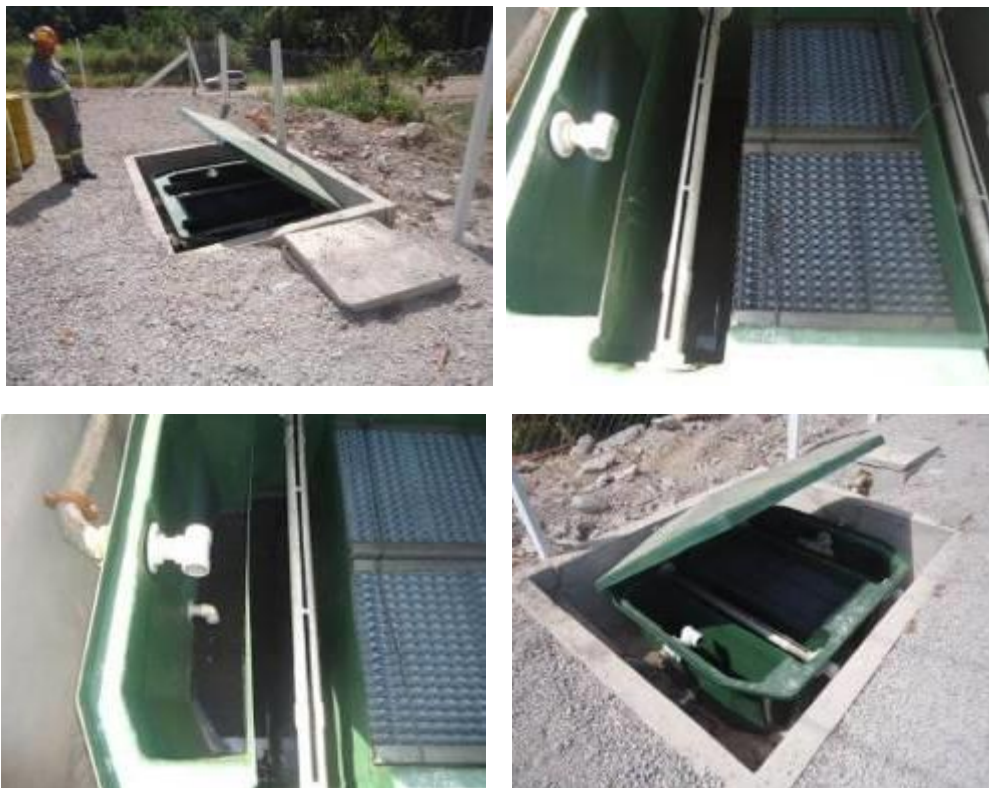
Realização de limpeza e manutenção de caixa separadora de água e óleo da central geradora.
