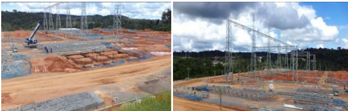
Subestação de energia na Margem Direita.
