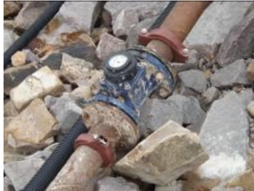
Detalhe do hidrômetro para acompanhamento/ monitoramento das quantidades de água reutilizada.
