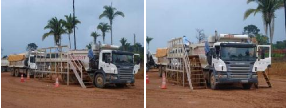
Escada e passarela para acoplamento de lona a fim de evitar ação do vento sobre material solto nos caminhões que trafegam no acesso interno do canteiro.
