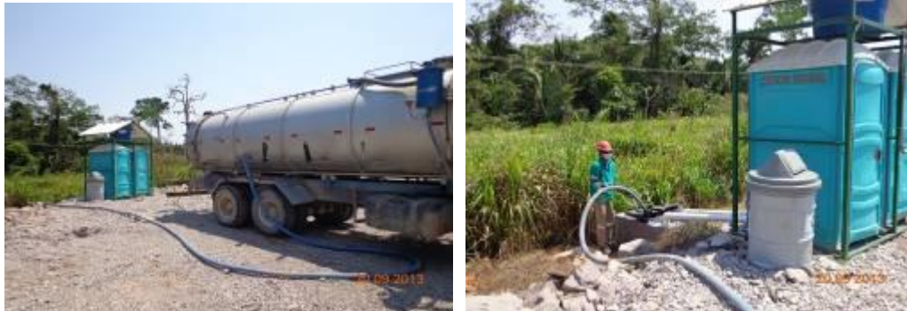
Banheiros químicos distribuídos no canteiro, limpeza periódica e recolhimento do efluente para a ETE.
