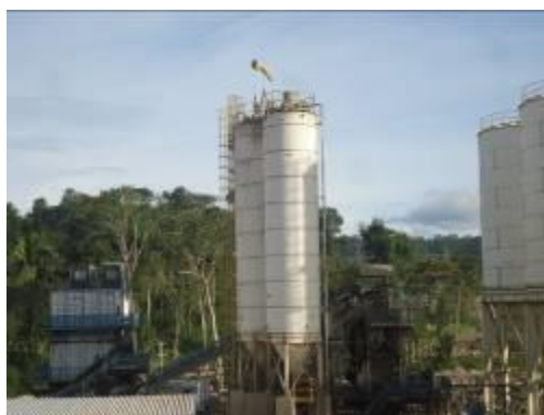
Silos de cimento com filtro para retenção de partículas em suspensão.
