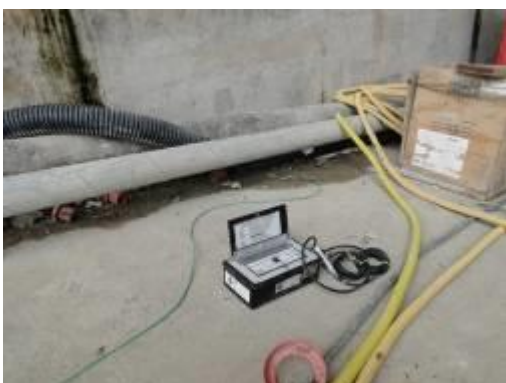
Monitoramento Casa de Força
