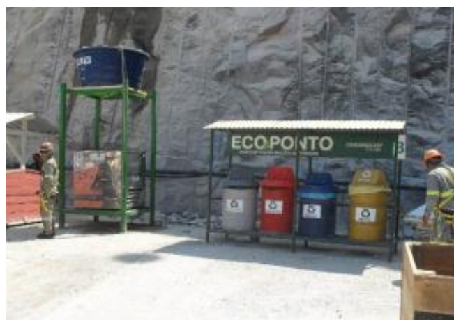
Ecopontos – estruturas dispostas em campo para atender a coleta seletiva e facilitar a segregação dos resíduos
