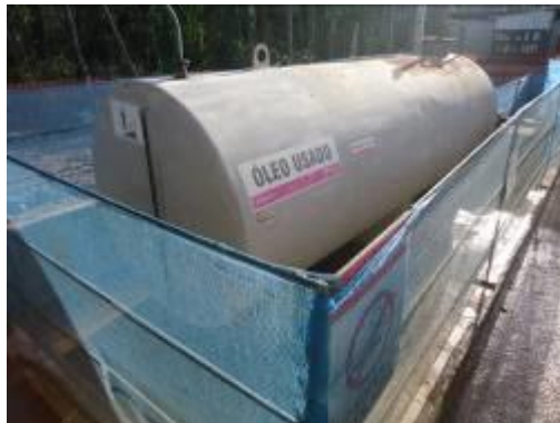
Tanque de armazenamento de óleo residual
