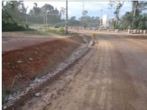
Canaleta com escada rochosa.
