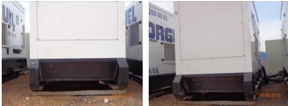
Geradores no campo com bandeja de contenção.
