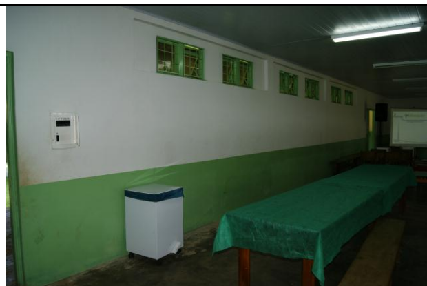
Figura 11: Reparo na Escola Jardim das Flores
