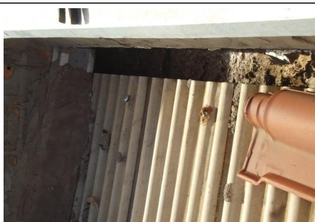
Figura 08: Vazamento na calha da caixa de água Unidade Previdenciária de Paranaíta.
