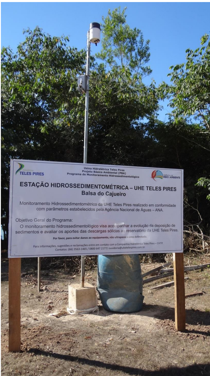
Figura 30 – Exemplo de placa de identificação colocada nas estações hidrossedimentométricas e meteorológicas. A foto mostra o pluviógrafo da estação hidrossedimentométrica Balsa do Cajueiro. Note que o pluviômetro foi posicionado com um poste longo para garantir a qualidade da medida de chuva.
