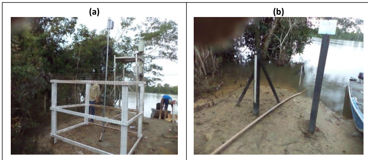
Figura 5. Montagem e instalação da estação telemétrica Jusante Foz Peixoto de Azevedo. (a) Visão geral da estação sendo montada com destaque ao pluviômetro; (b) Visão geral do local escolhido para a instalação da estação.
