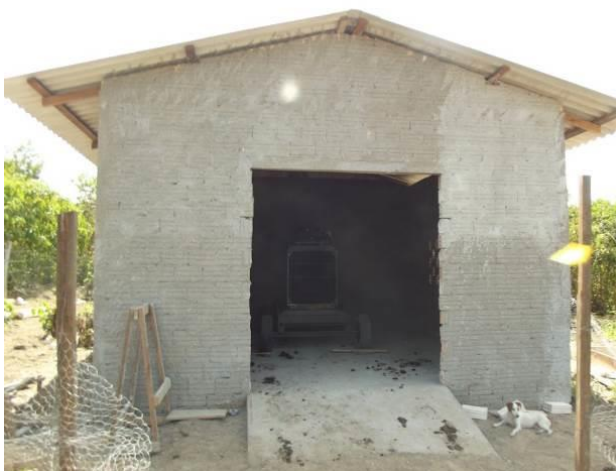
Figura 07: Gerador no interior do galpão construído para protegê-lo
