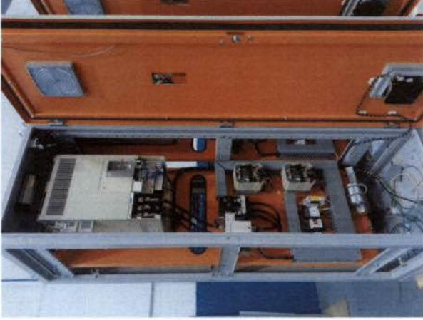
Detalhe painel Talha
