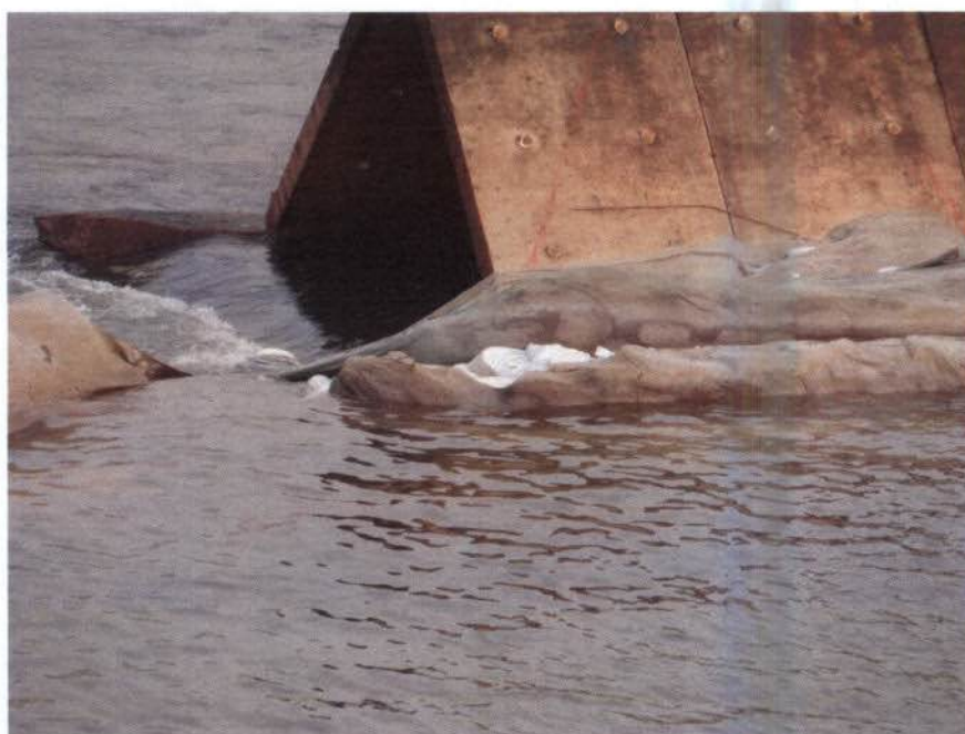
Abertura provocada pela força da água. Foto de 20/10/2015.
