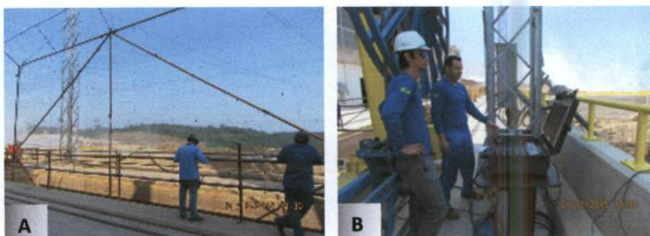
Prancha 06. Substituição da grade anticardume da UG 1 e Inspeção dos mergulhadores A – Retirada da grade da UG 3; B – Inspeção dos mergulhadores, UG 3 e 4.
