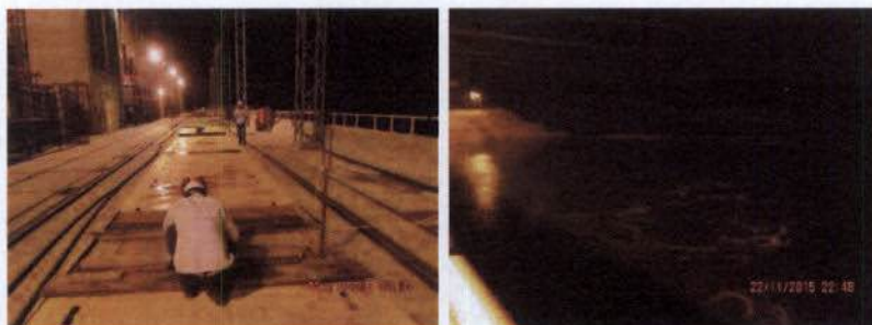
Prancha 2. Içamento das grades anti-cardume e visualização do canal de fuga após a partida da unidade
