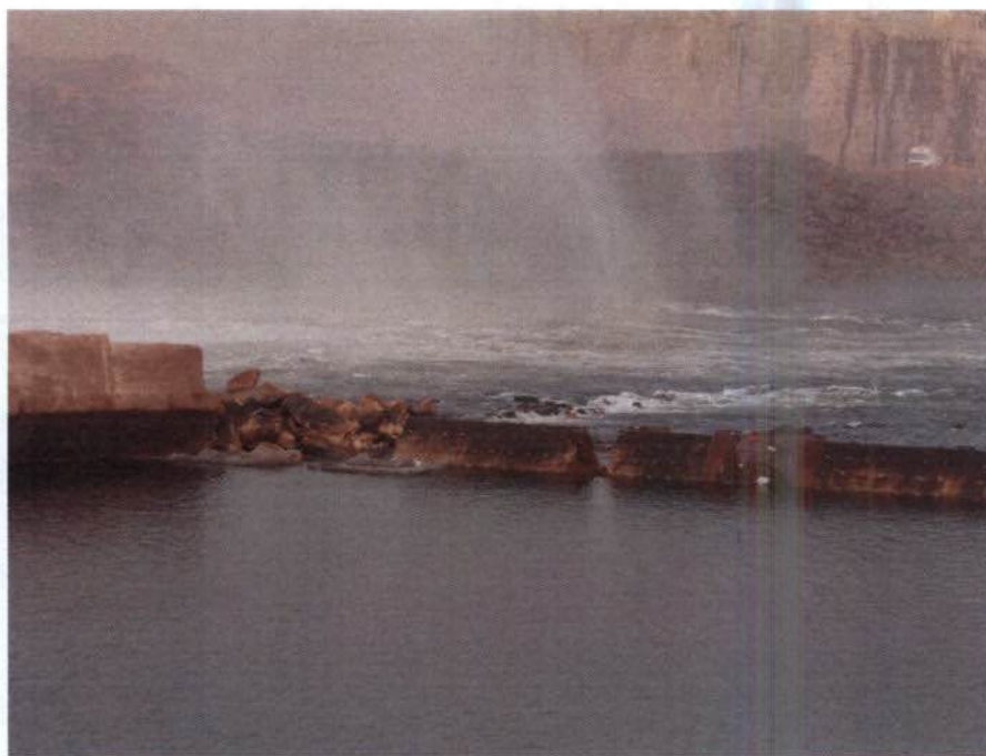
Situação após a realização dos primeiros testes com a abertura provocada pela força da água. Foto de 20/10/2015.
