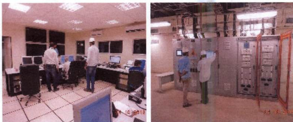
Prancha 16. A – acompanhamento na sala de controle; B – acompanhamento na galeria Elétrica.
