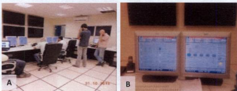
Prancha 23. A e B – Acompanhamento dos testes de rejeição de carga na sala de operação.
