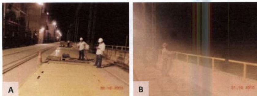
Prancha 22. A. Acionamento das grades anticavidades; B – Observação do canal de fuga durante os testes.
