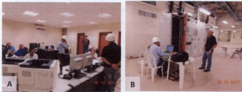
Prancha 07. A – Acompanhamento dos testes na sala de controle; B – Painel regulador de velocidade.
