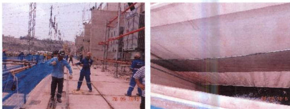
Prancha 05. A – instalação das telas de contenção de peixes; B – telas já colocadas no vão da UG02.
