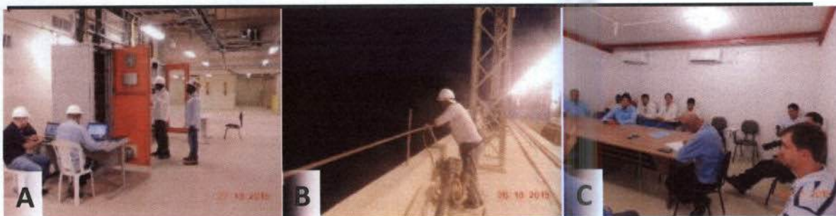
Prancha 01. (A) Acompanhamento ambiental na galeria elétrica os testes de comissionamento; (B) Acompanhamento ambiental do canal de fuga durante os testes de comissionamento; e (C) Participação do coordenador ambiental das reuniões diárias de comissionamento.
