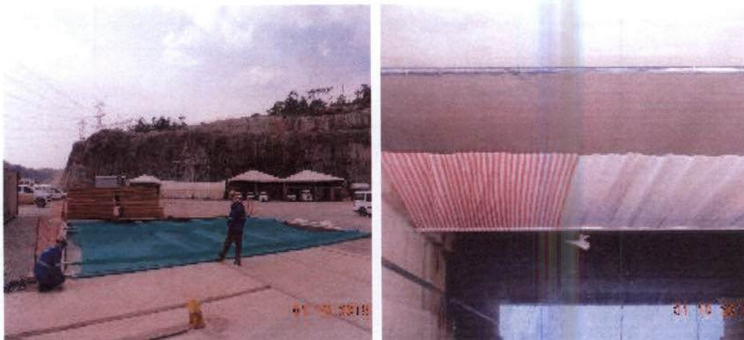
Prancha 11. A – Instalação da tela de contenção UG02; B – Tela instalada na UG02.
