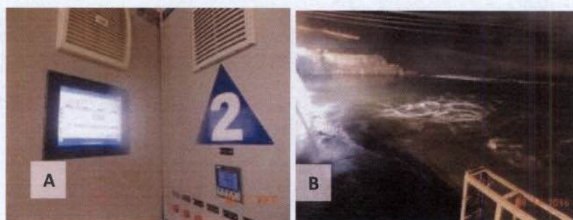
Prancha 50. A – Painel regulador de velocidade; B – Canal de fuga durante os testes de rejeições de cargas.
