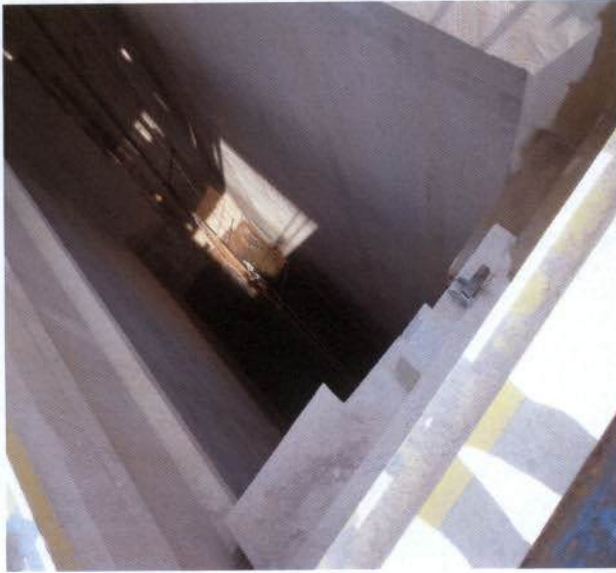
Figura 5 – Descida da tela anti cardume após o trip da unidade geradora.
