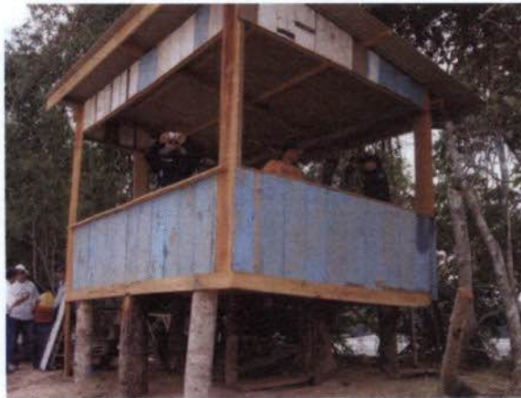
Foto 21. Madeira proveniente da supressão sendo utilizada no local para a construção de estruturas.
