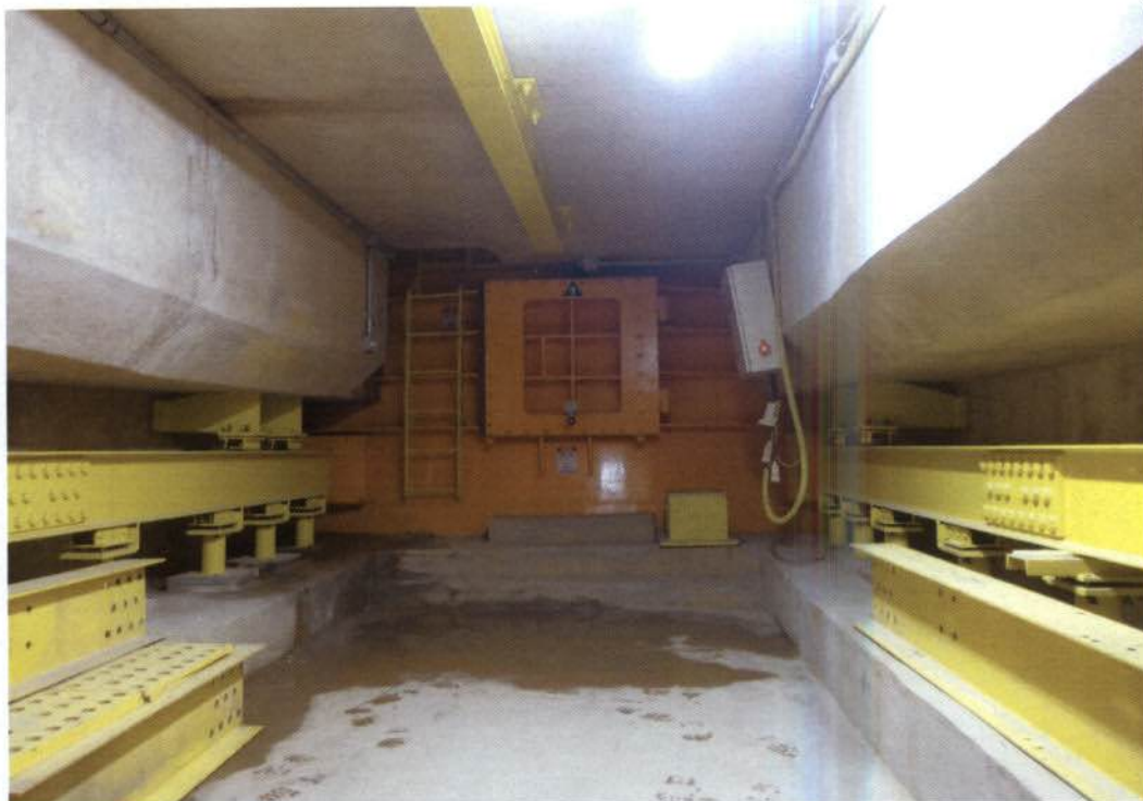
Figura 3 – Escotilha da resgate de peixes dentro do conduto da unidade geradora.
