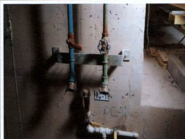
Foto 17 – Tubulações responsáveis para condução de água e oxigênio para interior da 1ª turbina. Unidade Geradora (UG – 01).
