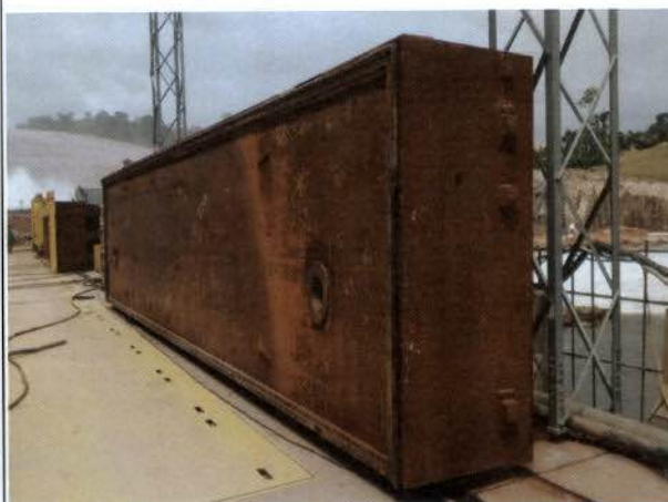
Foto 14 – Stop-logs na parte superior da casa de força da UHE Teles Pires.
