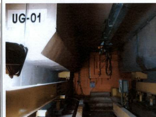
Foto 18 – Acesso a 1ª turbina (UG – 01) na parte inferior da casa de força da UHE Teles Pires.
