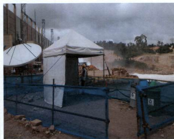
Foto 15 – Instalação para avistamentos de peixe durante o comissionamento das turbinas pela equipe de resgate.
