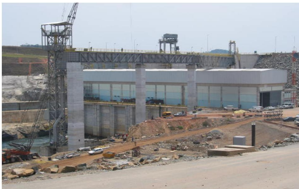
Foto 1 - Vista Geral de Elevador de Peixes
