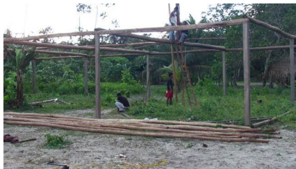
Foto 26: Detalhe de construção de salão para a festa do Mbotawa na aldeia Kampinhu-hu (12/11/14).
