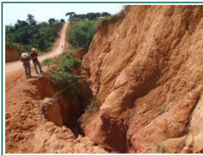
Foto 10: Processo erosivo em estrada rural
