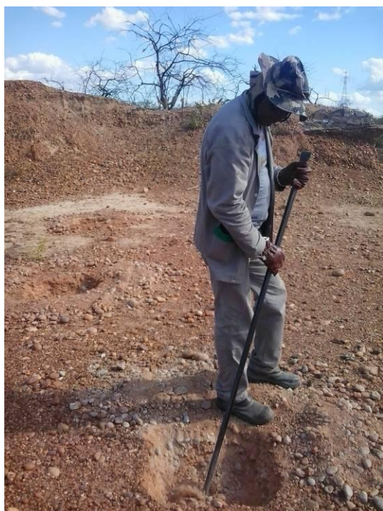
Foto 3 - Início dos trabalhos de preparo do solo e abertura de covas na área A.
