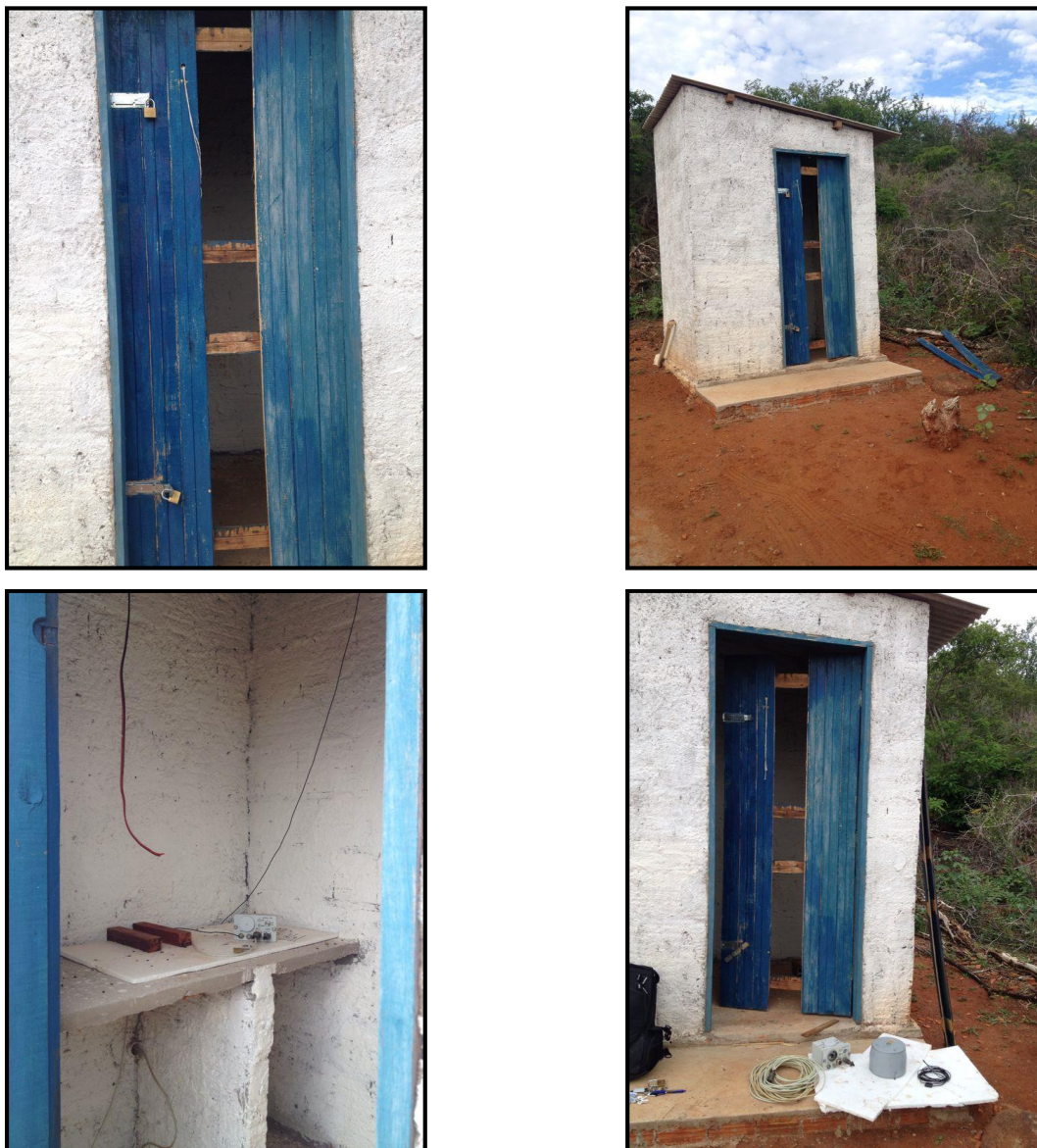
Figura 32: Arrombamento ocorrido no dia 12.03.14 no abrigo da estação sismográfica de Sobradinho (SOB 02).
