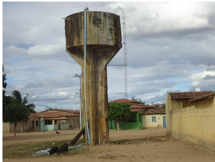
Figura 27 - Comunidade Retiro de Cima - Sento Se - Estação Elevatória, distribuição de água sem tratamento
