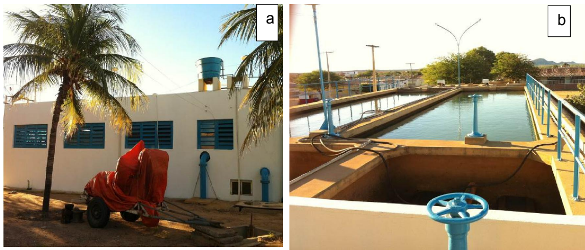
Figura 6 - a) ETA da Vila São Francisco; b) Detalhe dos flocladores e decantadores;
