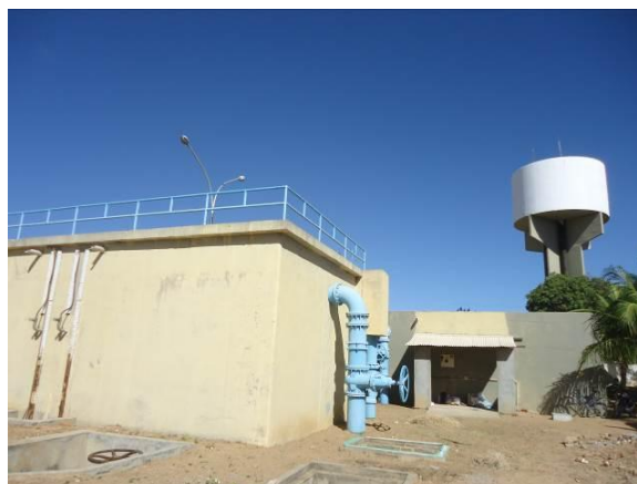
Figura 7 - ETA Vila São Joaquim
