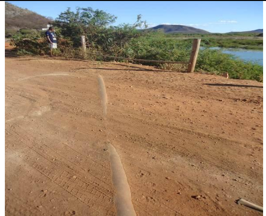
Figura 16 - - Detalhe da adutora de água bruta.
