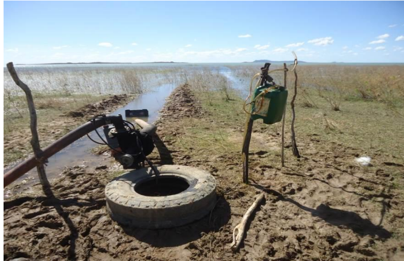
Figura 43 - Motor bomba a diesel próximo ao Reservatório, Comunidade Algodões – Ponto 37 - Sobradinho/Ba
