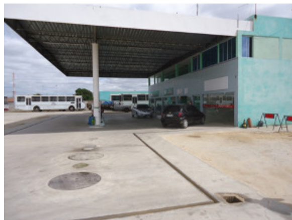
Figura 38 - Posto, detalhe da canaleta que coleta os resíduos a uma caixa separadora de água e óleo.
