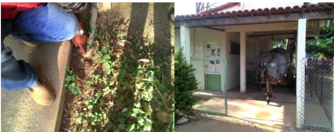
Figura 112 - Fazenda Pritan, canal de escoamento encontra-se danificando, lançando efluente da lavagem diretamente no solo.
