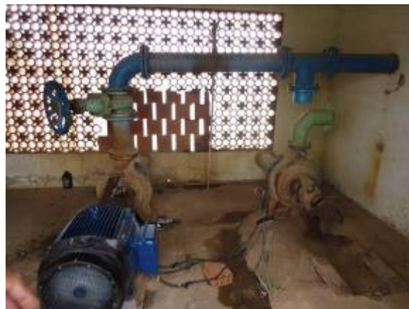
Figura 6 - Elevatória de água tratada
