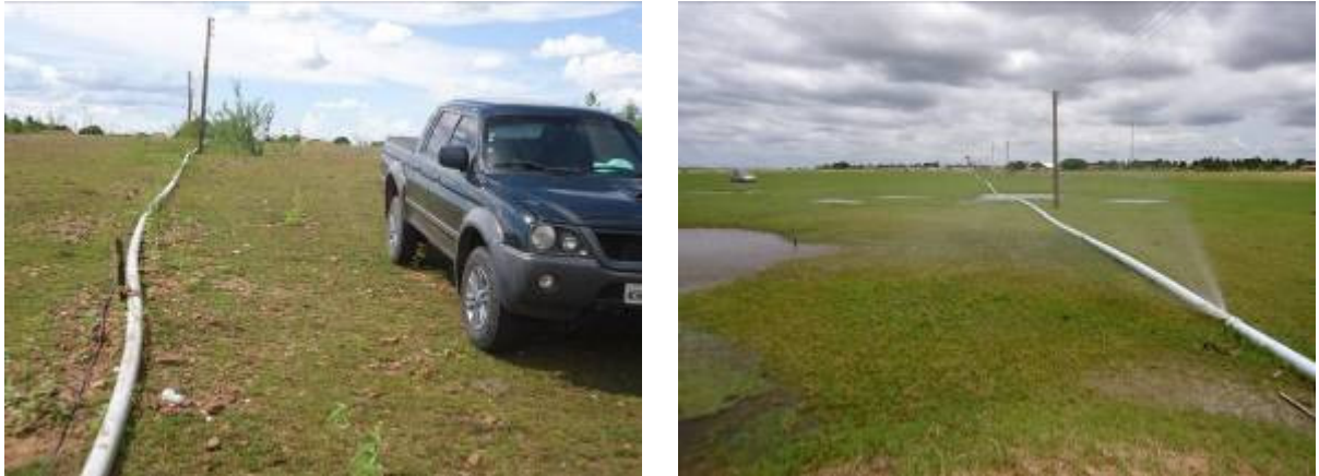
Figura 9 - a) Detalhe da adutora de água bruta.- Bem Bom; b) Detalhe da adutora de água bruta com vazamentos – Pau a Pique.
