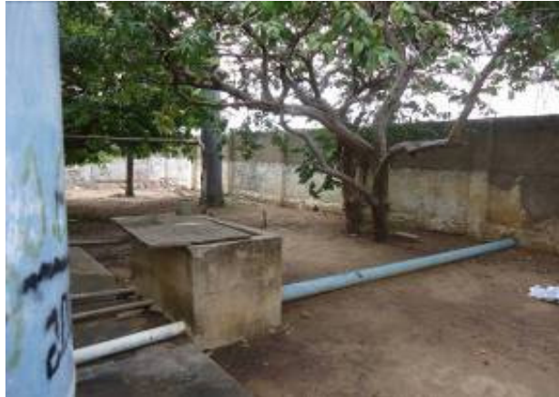
Figura 31 - Caixa de passagem da água de lavagem dos filtros, as quais estão sendo conduzidas diretamente para o reservatório de Sobradinho.
