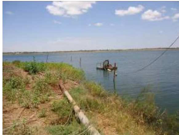
Figura 4 - Detalhe da adutora de água bruta e captação de água bruta do Município de Casa Nova – Ba.
