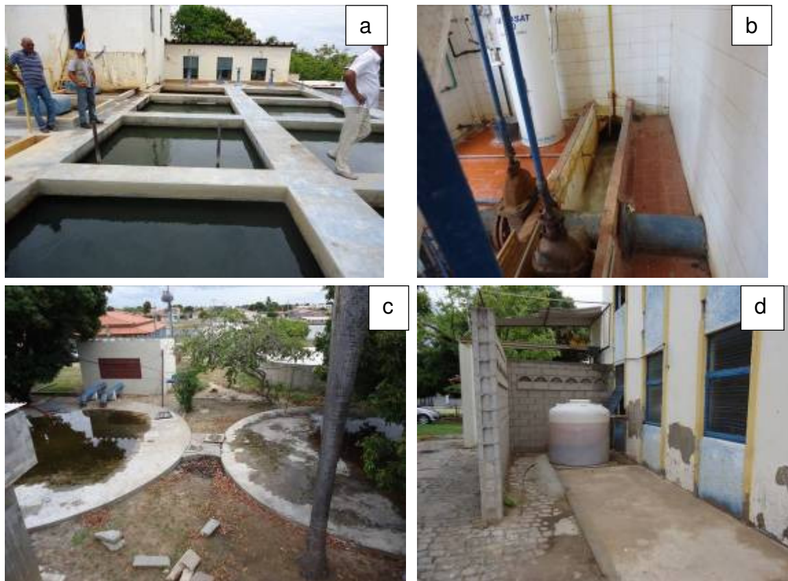
Figura 19 - a) ETA - detalhe dos decantadores; b) Calha para tratamento da água (detalhe da fluoteração e cloração); c) Reservatórios enterrados e casa de bombas ao fundo; d) Local de armazenamento do cloro.
