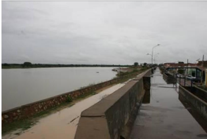
Foto 46: “Muralha” construída para contenção de enchentes. Hoje obsoleta e servindo para subcomércio e abandono.
