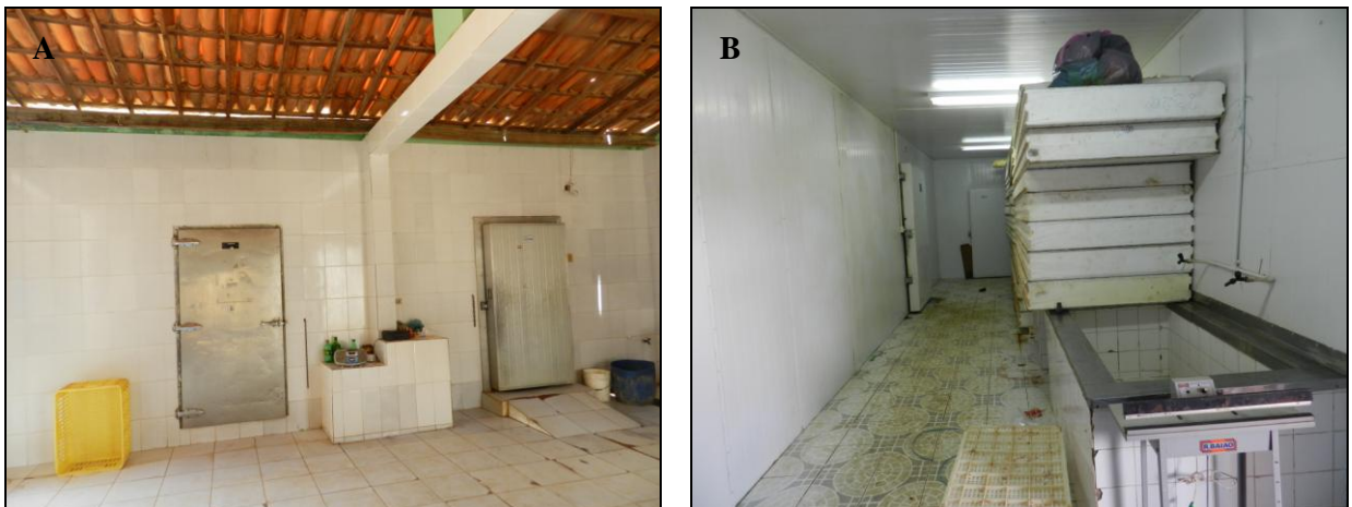
Foto 37: A – Câmara de resfriamento e câmara fria, Frigorífico Ribeiro em Xique-Xique; e, B – Corredor de acesso a câmaras frias da empresa Comércio de Pescado São Francisco em Xique-Xique (Imagem Rogério Cavalcante)
