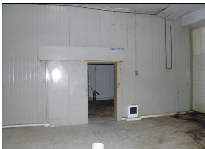
Foto 93 – Câmara fria do Terminal Pesqueiro de Sobradinho.
