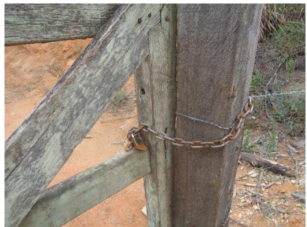
Foto 78: Detalhe do cadeado restringindo a entrada.
