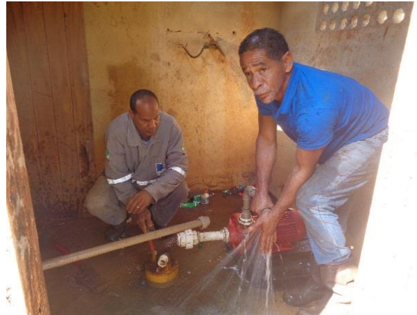
Foto 76: Verificação de bomba, por bombeiro hidráulico.
