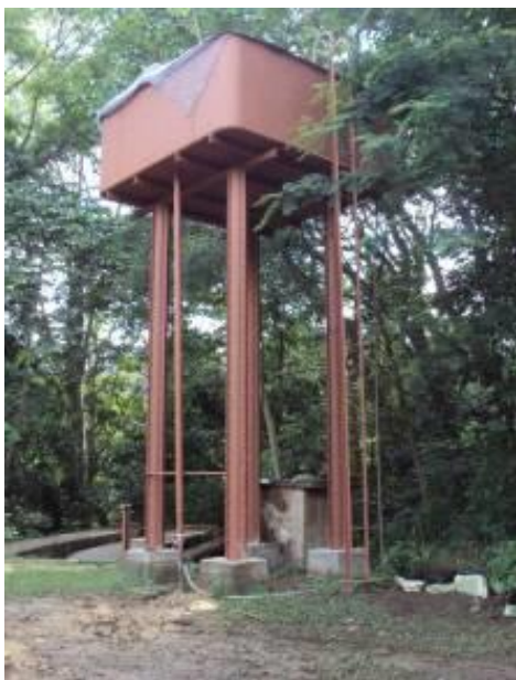
Foto 48: Caixa de água limpa e pronta para uso.
