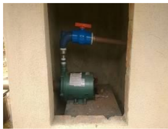
Foto 53: Bomba abrigada na casa de bomba.
