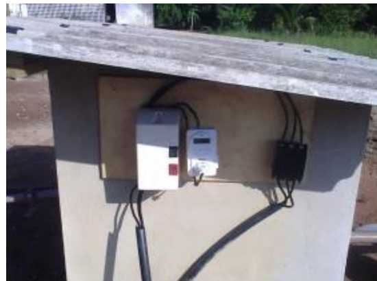
Foto 55: Painel elétrico da bomba.
