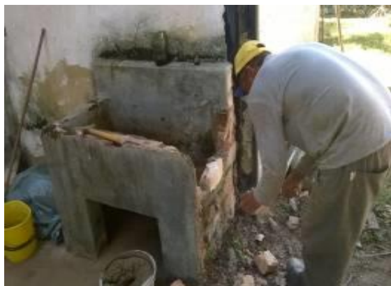
Foto 43: Tanque antes da reforma.
