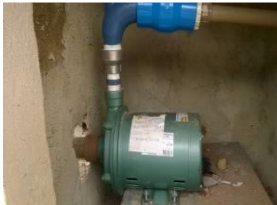
Foto 54: Vista da bomba com especificações sempre expostas.
