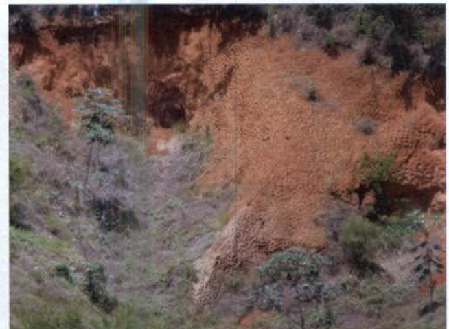
Foto 40: detalhe do interior da erosão 3.
