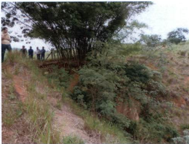
Foto 37 - Porção inicial da Erosão 1.
