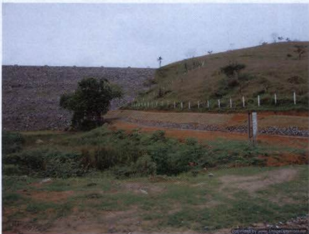
Foto 31: Instalação de filtro invertido junto à ombreira esquerda na face de jusante do dique Norte, sem anuência do Ibama.
