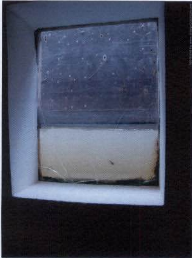
Foto 53: Janela da sala de monitoramento do STP da Barragem de Anta com várias rachaduras.
