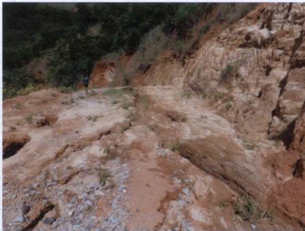
Foto 07: leito estradal da estrada de serviço junto à ombreira esquerda do dique Louriçal I, em péssimo estado de conservação e com acesso somente a pé.
