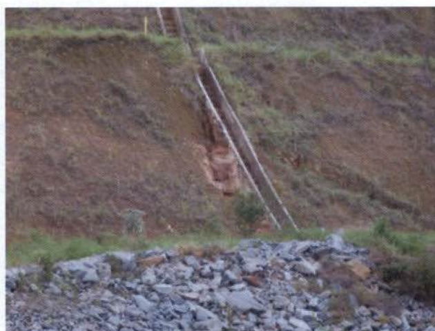
Foto 27: formação de processo erosivo ao lado de descida d'água em degraus – Desemboque Canal 5.
