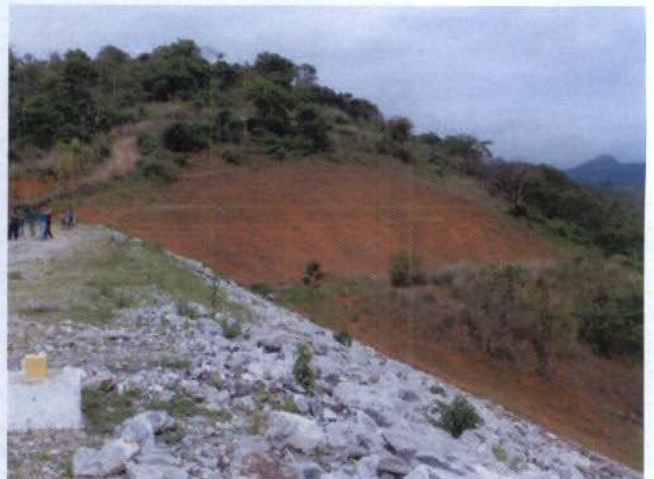
Foto 30: ausência de cobertura vegetal em talude presente próximo ao dique Estaca 2.
