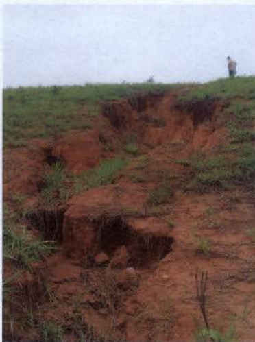
Foto 57: Erosão na Área 1 da revegetação da APP.
