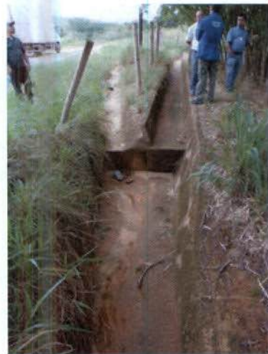
Foto 38: Sistema de drenagem implantado na região da Erosão 1.
