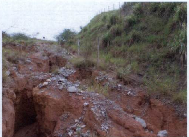
Foto 46: processo erosivo em desenvolvimento na estrada de acesso ao Bota Fora 17. O processo erosivo está se aproximando de canaleta de drenagem.
