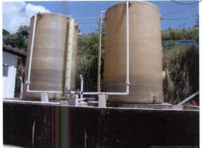
Foto 48: Tanques de recebimento de chorume ocupado por material líquido.
