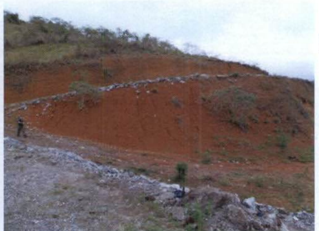
Foto 22: Ravinamentos presentes na ombreira direita.
