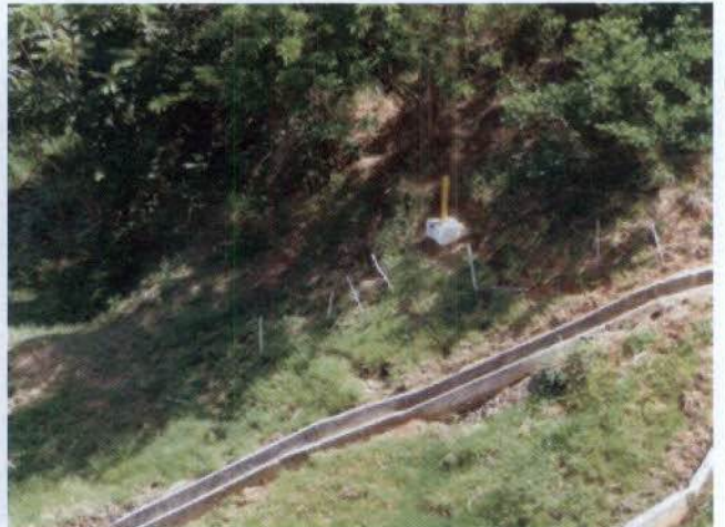
Foto 34: Estacas tombadas a jusante da ombreira direita do dique Lourçal 1, demonstrando movimentação de terra.
