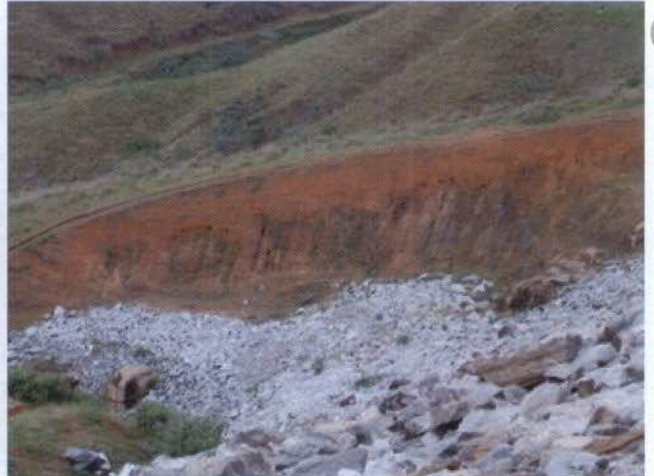
Foto 22: Foco erosivo junto à ombreira direita do dique Antonina.
