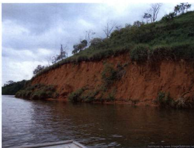
Foto 17: Reservatório Caçados. Desmoronamento de margem direita. Ponto GPS 105.
