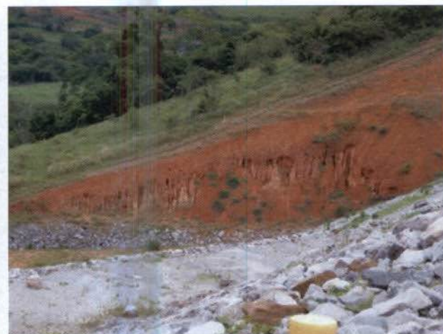
Foto 26: Processo erosivo em desenvolvimento na região do dique Estaca 2.
