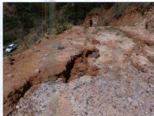
Foto 06: leito estradal da estrada de serviço junto à ombreira esquerda do dique Louriçal 1, em péssimo estado de conservação e com acesso somente a pé.
