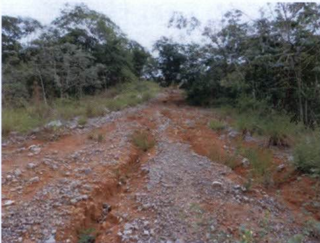
Foto 43: processo erosivo em desenvolvimento na estrada de acesso ao Bota Fora 17.
