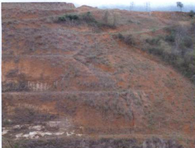
Foto 23: formação de processo erosivo no início da canaleta de pé de talude – Dique Sul.
