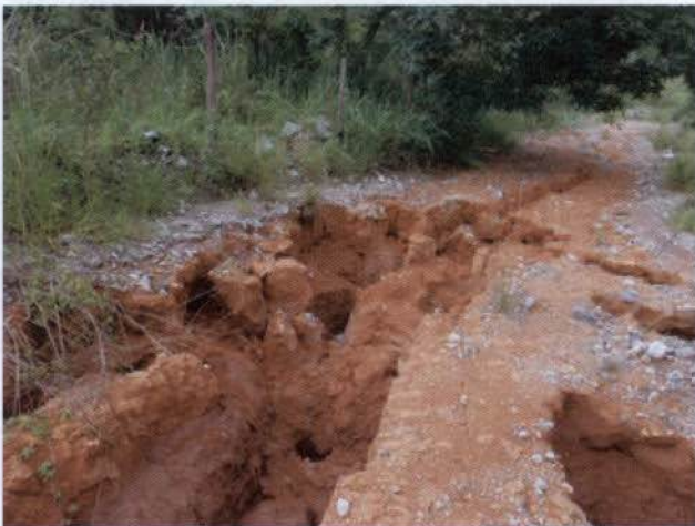
Foto 45: processo erosivo em desenvolvimento na estrada de acesso ao Bota Fora 17.
