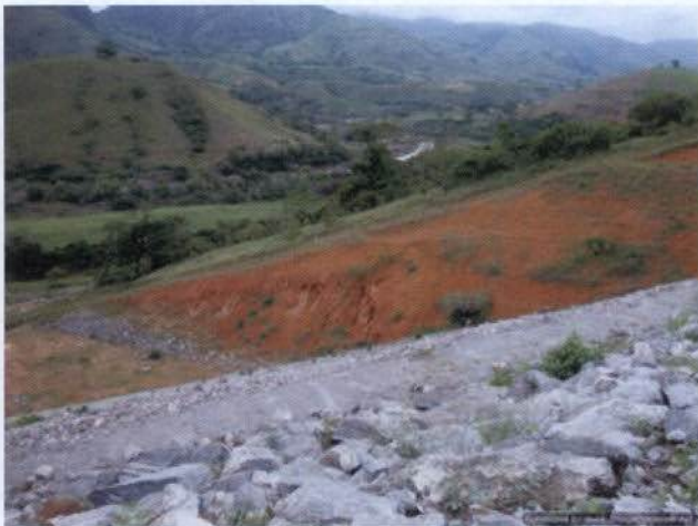
Foto 21: Foco erosivo junto à ombreira direita dique Estaca 2
