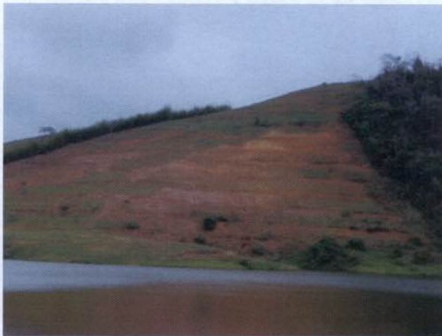
Foto 29: ausência de cobertura vegetal em talude presente no reservatório Antonina.
