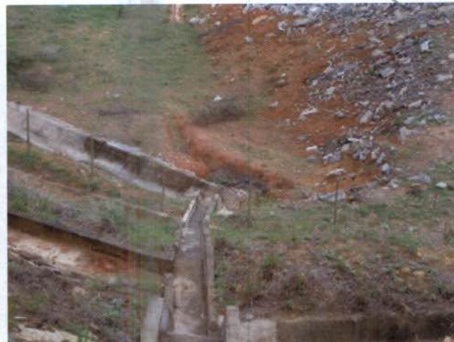
Foto 24: Formação de processo erosivo ao final de descida d'água em degraus – Dique Sul.
