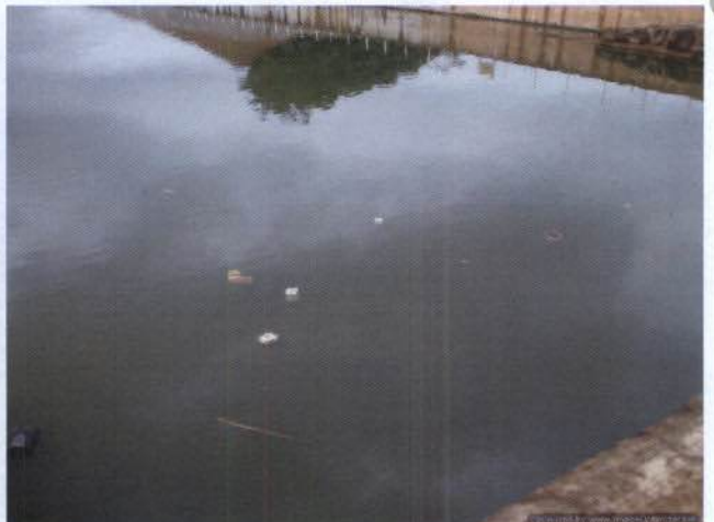
Foto 10: Canal de adução da usina Simplício. Presença de Lixo.
