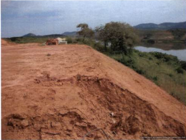
Foto 79: Platô principal aberto como objetivo de construir imóvel pelo infrator. Ao fundo presença de material de construção. No talude presença de sulcos erosivos acentuados pela ausência de técnica adequada, com indício de riscos por instabilidade.
