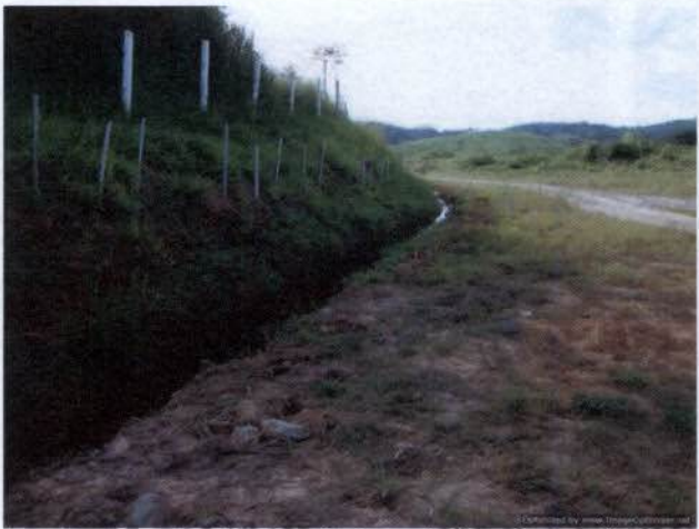
Foto 27: Marcação do maciço à direita do dique Norte. Área com umidade.
