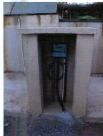
Foto 34: Equipamento de Controle vazão efluente x injeção chorume. ETE sapucaia.
