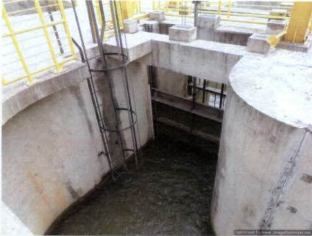
Foto 55: STP da UHE Anta (escada de peixes).
