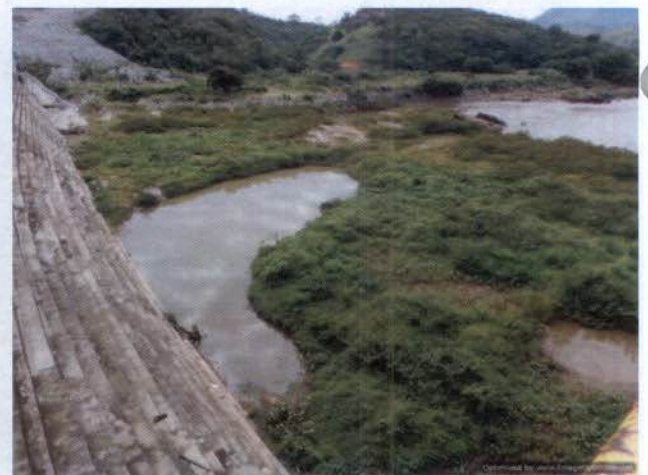
Foto 54: Poças na área imediatamente a montante do barramento da usina Anta.
