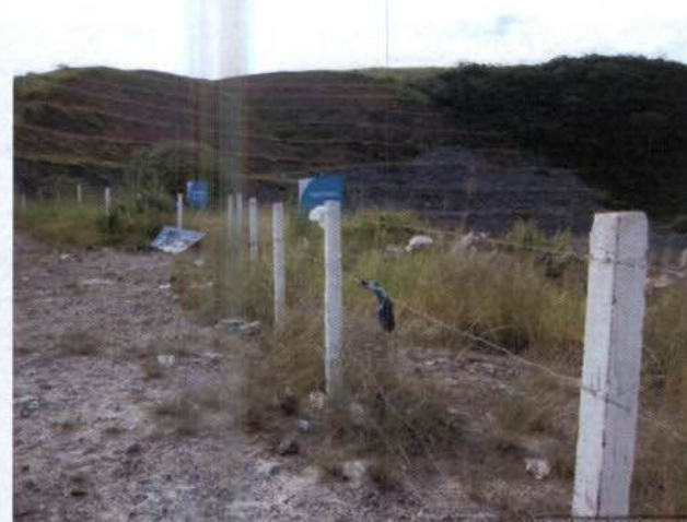
Foto 10: MG 126 próxima ao desemboque túnel C5, cercada e com sinalização de advertência.
