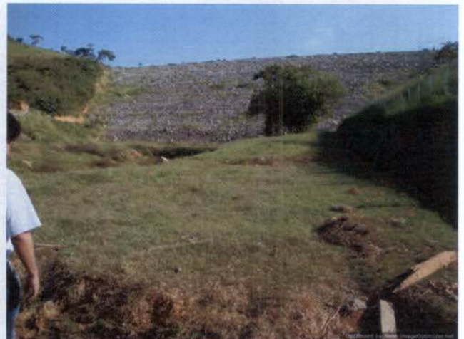
Foto 26: Dique Norte, Reservatório de Peixes onde está ocorrendo Fuga d'água pelas ombreiras direita e esquerda.
