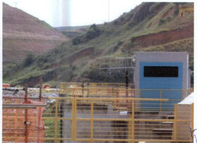
Foto 60: Antena para monitoramento por telemetria.
