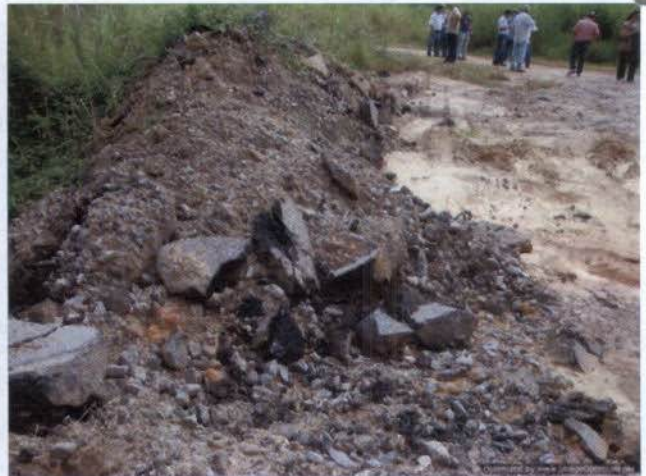
Foto 04: Bota fora / BR 393 – PRAD pendente com presença de rejeitos do decapeamento do asfalto dos trechos da BR393 desmobilizados.
