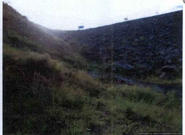
Foto 28: Dique Lourçal 1, Reservatório de Lourçal, onde está ocorrendo Fuga d'água pela ombreira esquerda.
