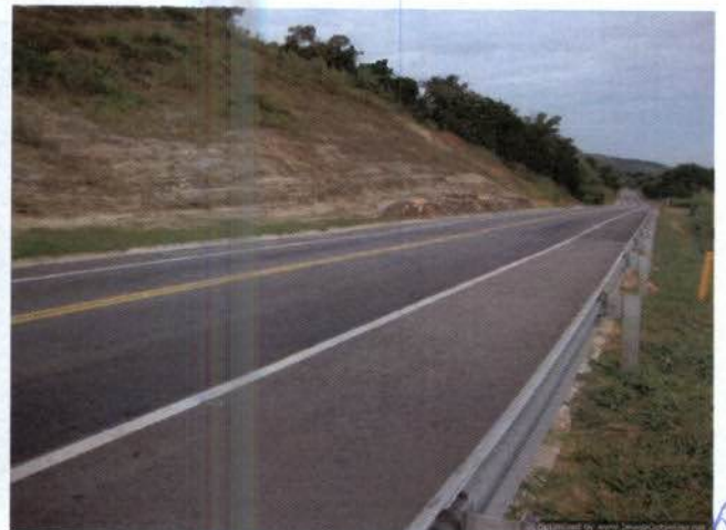
Foto 48: BR 393 em local do acesso à futura ponte de acesso à usina Simplício.
