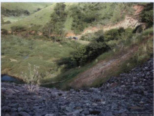
Foto 29: Marcação do maciço à esquerda do dique Lourçal 1 da área com umidade, beirando escada de drenagem.
