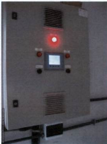
Foto 33: Equipamento Interfasse Homem Máquina (IHM) para controle de injeção do chorume. ETE Sapucaia.
