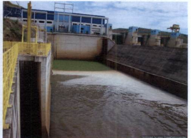
Foto 14: Canal de fuga da Usina Anta bloqueado por sedimentos.
