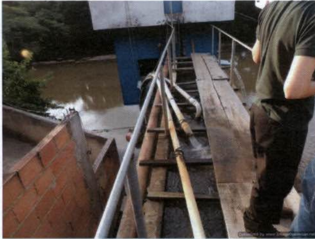
Foto 31: Tubulação mostrando bombeamento normal da bomba da CEDAE, RJ.
