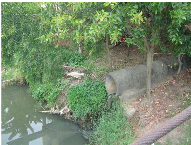
FIGURA 13 LANÇAMENTO DE ESGOTO NO RIO PARAÍBA DO SUL ATRAVÉS DA REDE DE DRENAGEM NO CENTRO DE SAPUCAIA. EXEMPLO DE POLUIÇÃO DIFUSA. (N 7566147 / E 714925)
