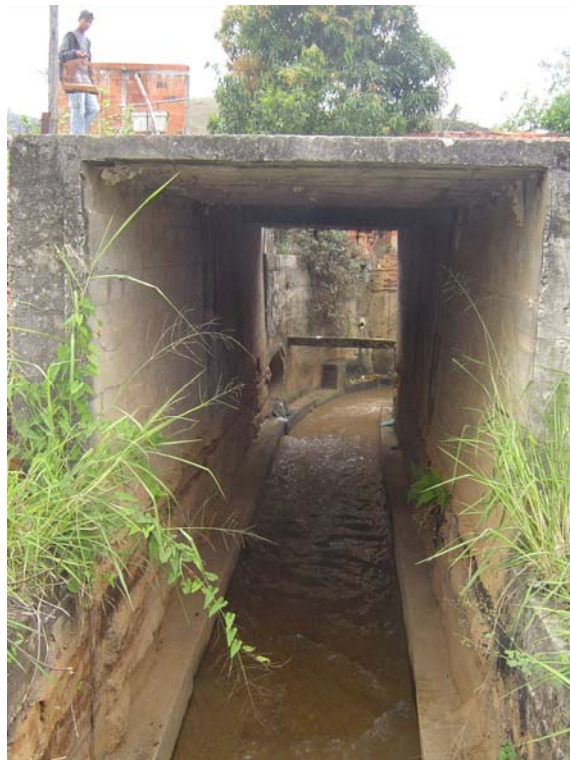
FIGURA 47 CÓRREGO QUE RECEBE OS ESGOTOS DOMÉSTICOS DA MAIOR PARTE DO DISTRITO DE ANTA E LANÇA NO RIO PARAÍBA DO SUL (N 7562041 / E 707589)
