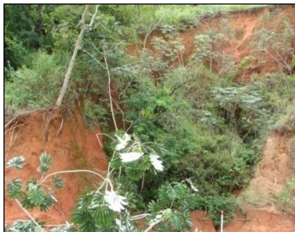
Figura 2.48 Detalhe da lateral esquerda da erosão 12, observa-se a regeneração da vegetação nativa ocorrida em seu interior
