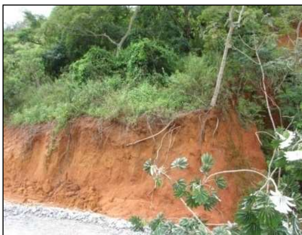
Figura 2.49 Detalhe de talude adjacente à erosão 12
