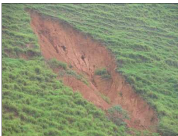
Figura 2.43 Vista frontal da erosão 10
