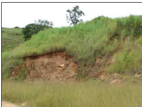
Figura 2.31 Detalhe de afloramento rochoso e contato solo-rocha, que poderá se tornar ponto de extrema instabilidade com o enchimento do reservatório
