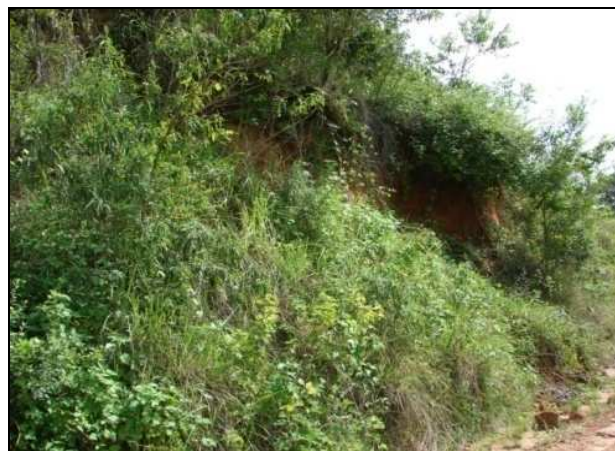
Figura 2.34 Detalhe a jusante da erosão 7, observando o desenvolvimento de vegetação herbácea e arbustiva no local
