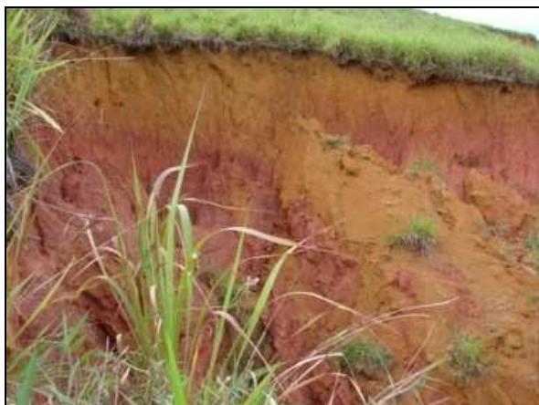
Figura 2.41 Detalhe de desmoronamento ocorrido na porção direita da erosão 9
