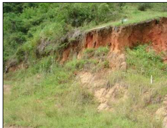
Figura 2.26 Presença de vegetação herbácea recém estabelecida nos taludes da erosão 4
