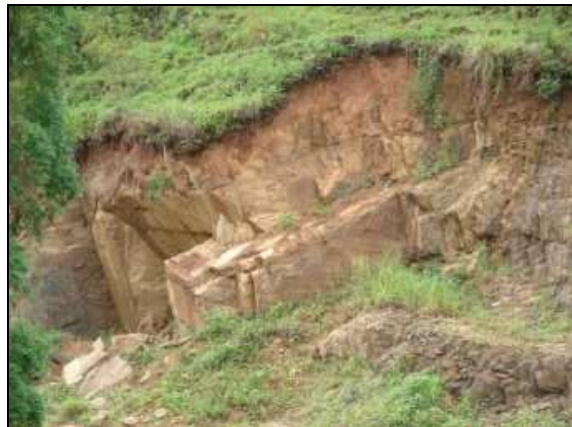
Figura 2.23 Detalhe de afloramento rochoso e contato solo-rocha, que poderá se tornar ponto de extrema instabilidade com o enchimento do reservatório
