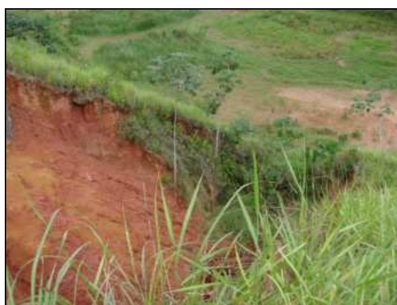
Figura 2.40 Vista a montante da porção esquerda da erosão 9
