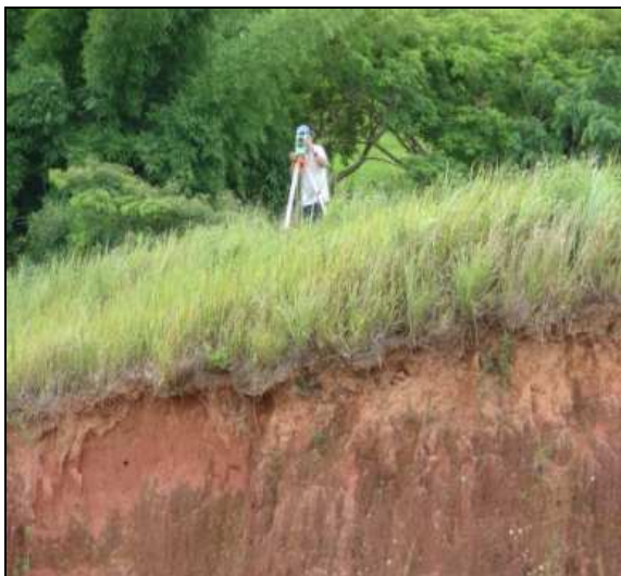
Figura 2.12 Detalhe da borda da erosão, em área de solo coluvionar
