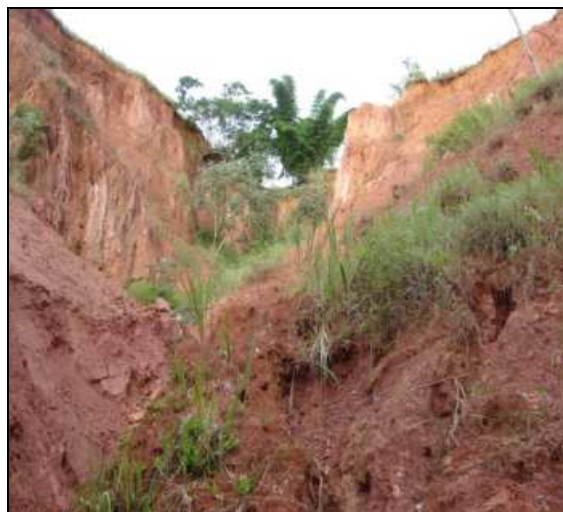
Figura 2.8 Vista a jusante do terço inferior da erosão
