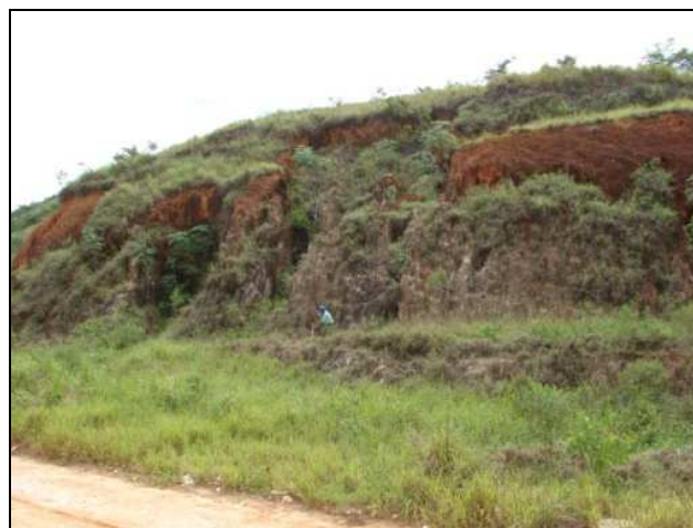
Figura 2.17 Detalhe a jusante de área localizada na porção central da erosão
