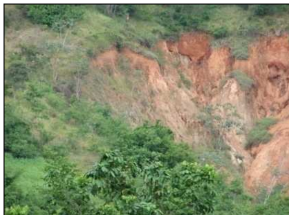
Figura 2.20 Detalhe lateral da erosão 3, observa-se o pleno desenvolvimento da vegetação no entorno deste processo erosivo
