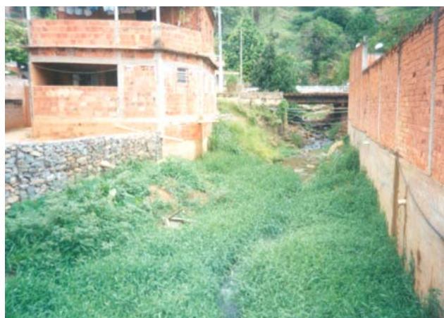
Figura 13-51 Sapucaia - Bairro São João - Córrego São João
