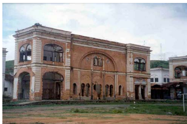
Figura 3-21 Ruínas da Rede Ferroviária
