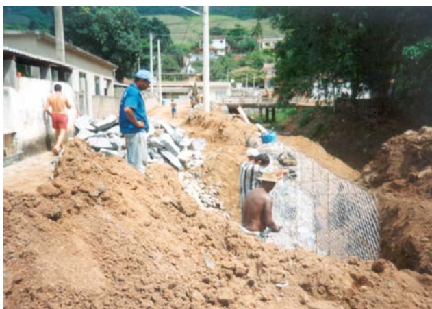
Figura 13-50 Sapucaia - Córrego São João - Tratamento de esgoto do bairro.
