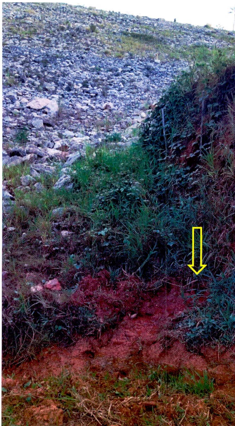
Foto 6: Olhos d'água na ombreira, imediatamente a jusante do offset da estrutura de barramento - Observar a saturação da quase totalidade do talude de solo natural, bem acima das estacas que demarcam a posição da área saturada após a inspeção anterior.
