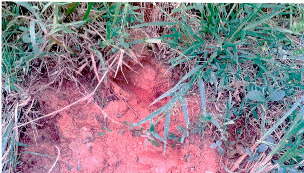
Foto 4: Detalhe do ponto de infiltração com pressão.
