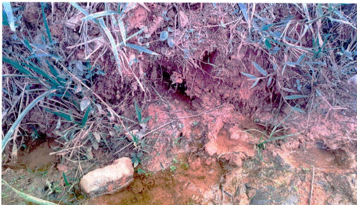
Foto 3: Detalhe do ponto de infiltração.
