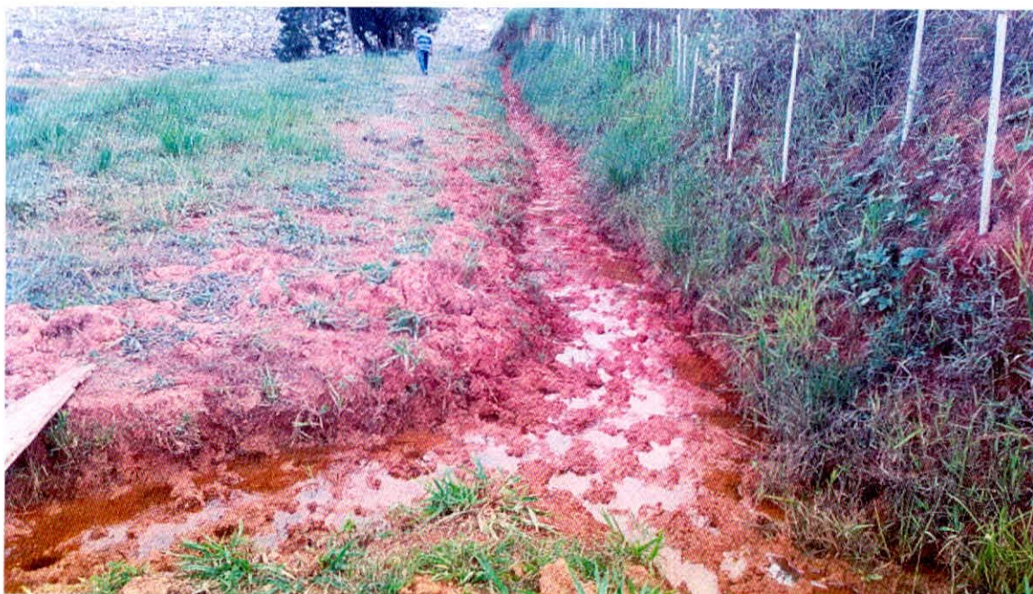
Foto 1: Detalhe da valeta de coleta de água completamente encharcada.
