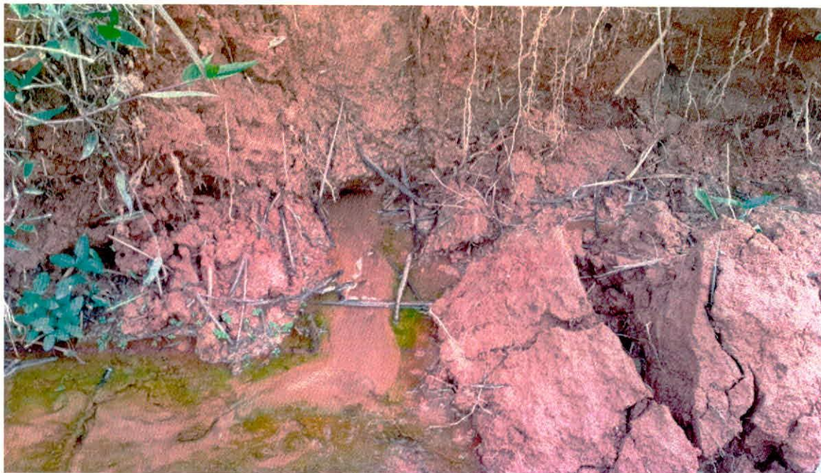
Foto 2: Detalhe do ponto de infiltração com pressão e carreamento localizado de finos.
