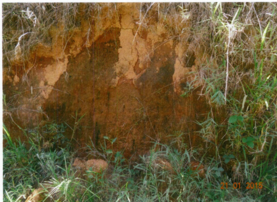
Foto 6: Dique Norte – Detalhe do talude lateral esquerdo parcialmente saturado.
