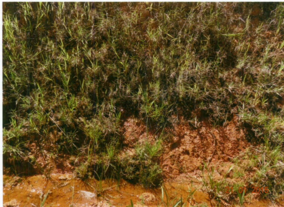
Foto 7: Dique Norte – Detalhe das surgências no talude lateral esquerdo.
