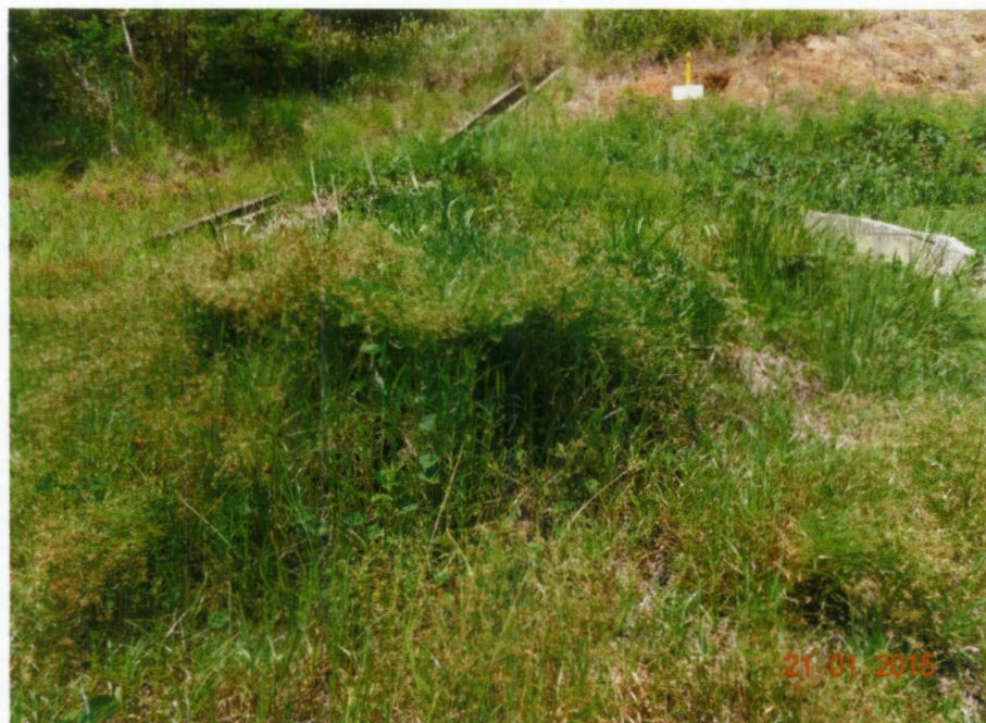
Foto 2: Dique Louriçal 1 – Detalhe da zona saturada.
