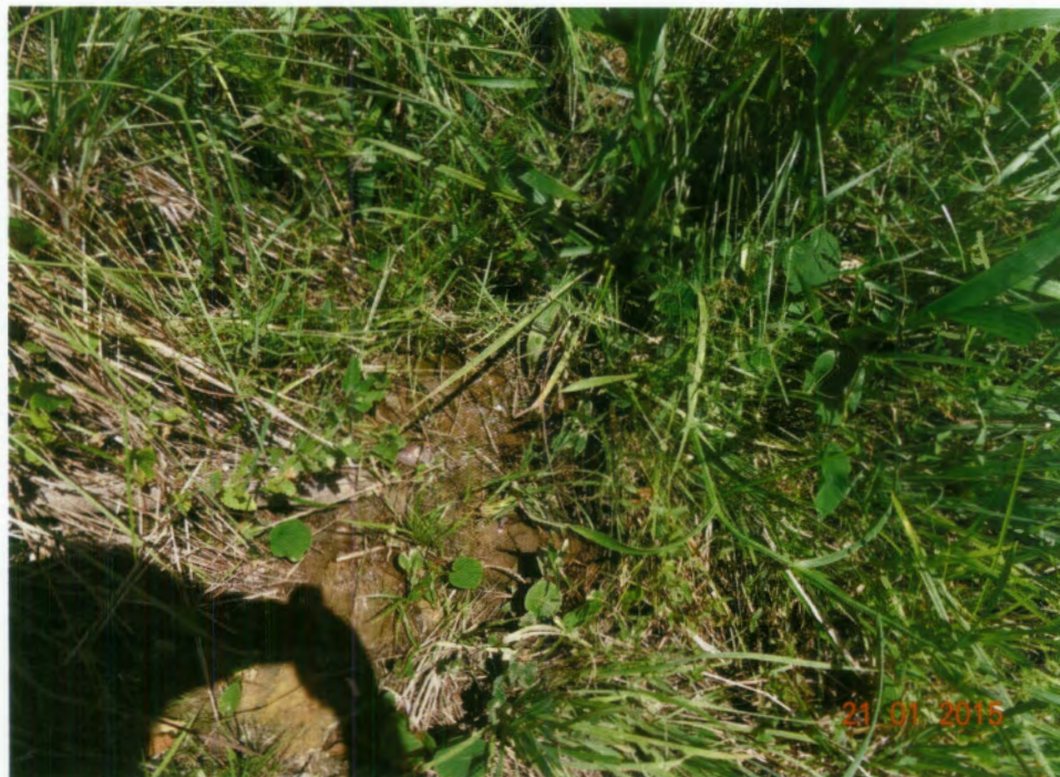
Foto 3: Dique Louriçal 1 - Detalhe de um ponto de surgência de água.
