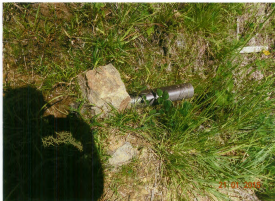
Foto 4: Dique Louriçal 1 - Detalhe do medidor de vazão instalado.
