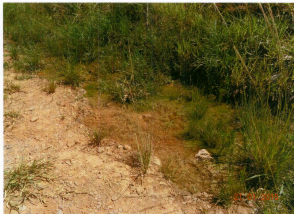
Foto 8: Dique Norte – Detalhe do empoçamento e escoamento das surgências de água.
