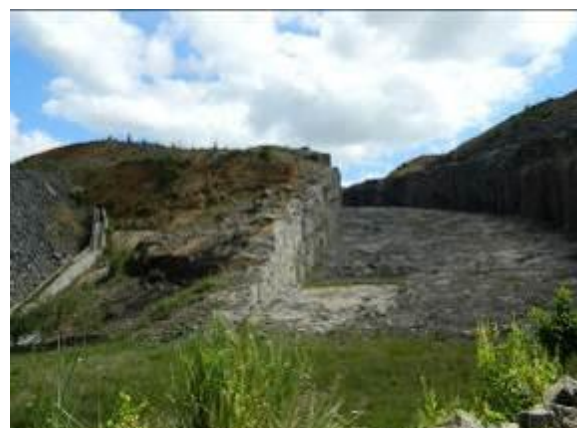
Figura 30 À direita, desvio para vazão de tromba d'água (quando houver), localizada próximo ao Dique Tocaia.
