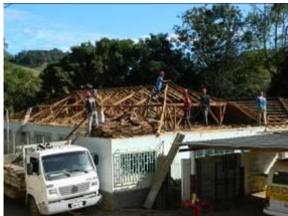
Figura 157 Reforma do telhado da escola, problema apontado no DRP
