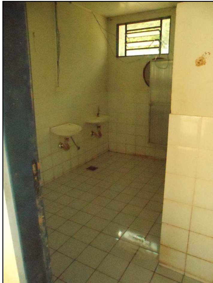
Figura 4: Banheiro do viveiro após a limpeza.
