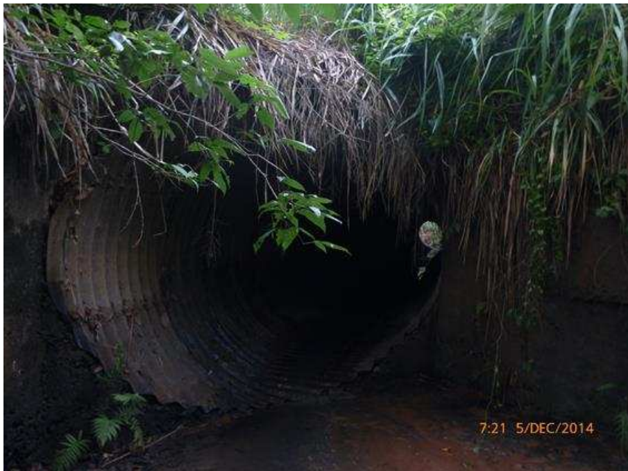
Figura 12 – Aspecto de uma grande manilha de aço sob uma rodovia BR-393 que serve de abrigo “digestório” para os morcegos hematófagos.
