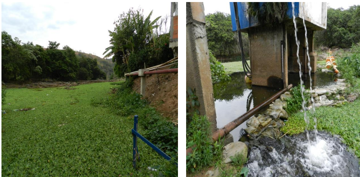
Figura IV-10 – Estação PRB CEDAE, no rio Paraíba do Sul, estação de captação de água da cidade de Sapucaia/RJ.
