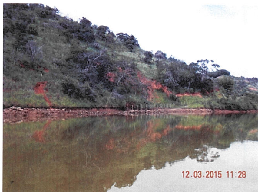
Foto II.2.1.11-2 – Março de 2015 – Vista geral Erosão 12, Observando que a área exposta na base da erosão é referente a amplitude do nível baixo do reservatório.
