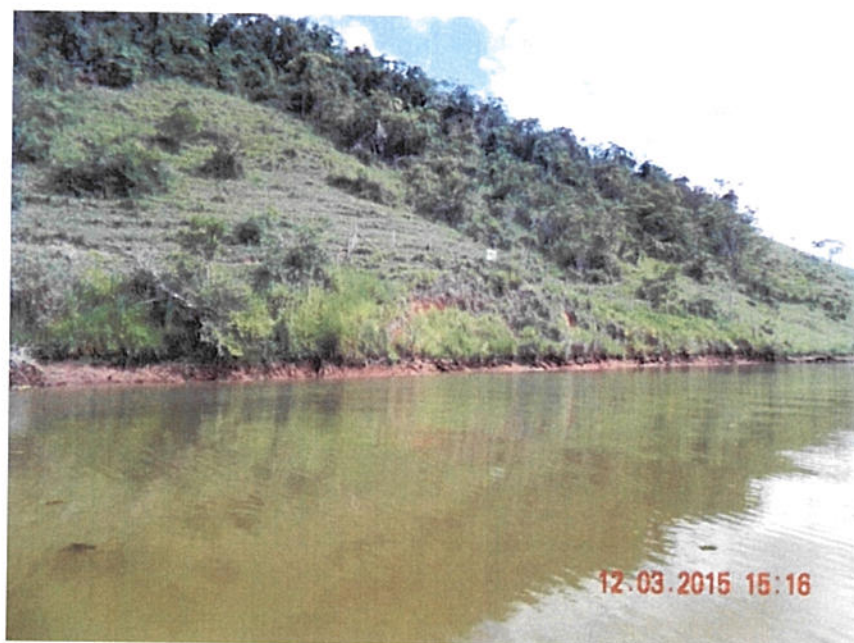
Foto II.2.1.5-2 – Março de 2015 - Vista geral do processo erosivo estabilizado. Observando que a área exposta é referente a amplitude do nível baixo do reservatório.
