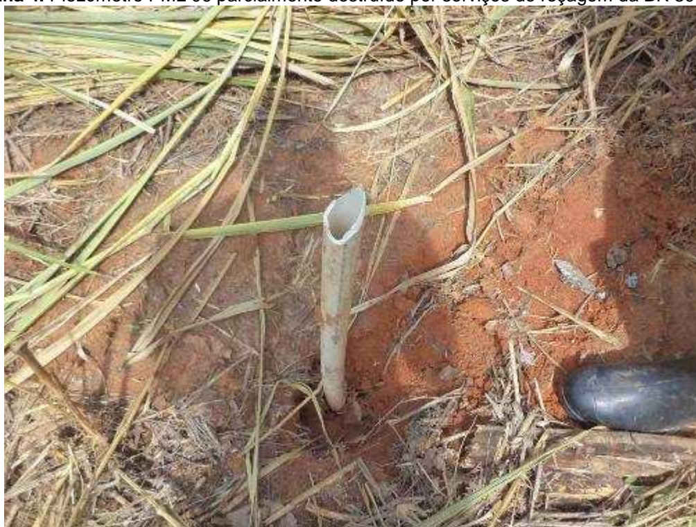
Fotografia 4. Piezômetro PML 06 parcialmente destruído por serviços de roçagem da BR 393.
