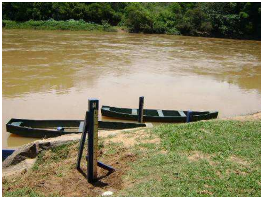
Figura 5.4 - Estação Fluviométrica Anta G
