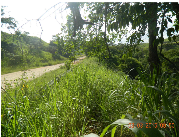
Foto 3.2.4-7 - MG 126 Seg. III, tratamento de erosão pré-existente, estabilizado. Coord. E-713.694; N-7.568.600.
