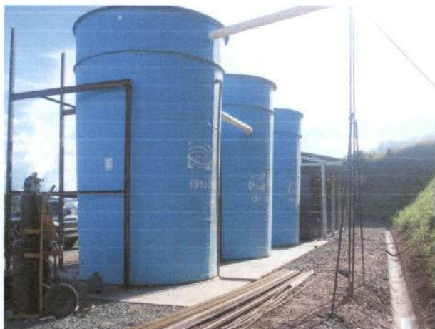
Foto 21 – Estação de Tratamentos de Esgotos
