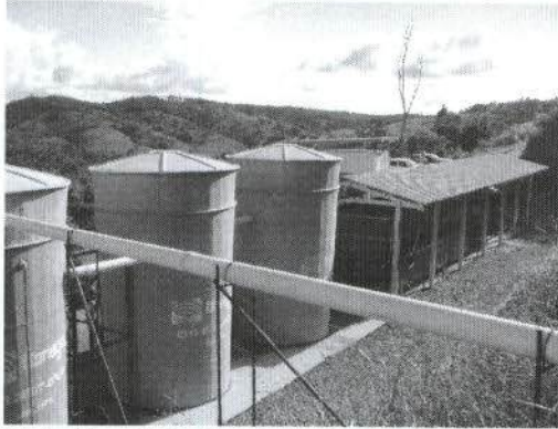
Foto 7 – Estação de tratamento de esgoto
