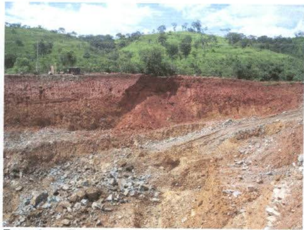
Foto 2 – Talude de solo localizado na pedreira. Observa-se que o mesmo apresenta evidências de desmoronamento, podendo vir a comprometer a rede de energia elétrica que passa pelo local.
