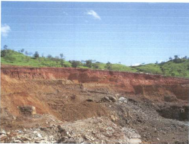
Foto 3 – Pedreira. Os taludes apresentam elevada inclinação, podendo ocorrer desmoronamentos.
