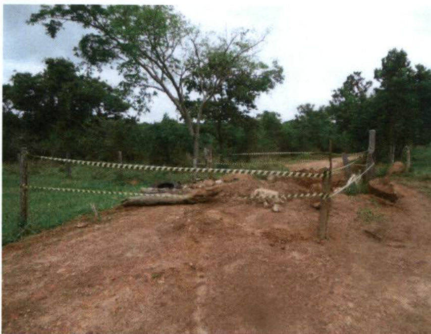
Local isolado após a retirada do mata-burro para manutenção.
