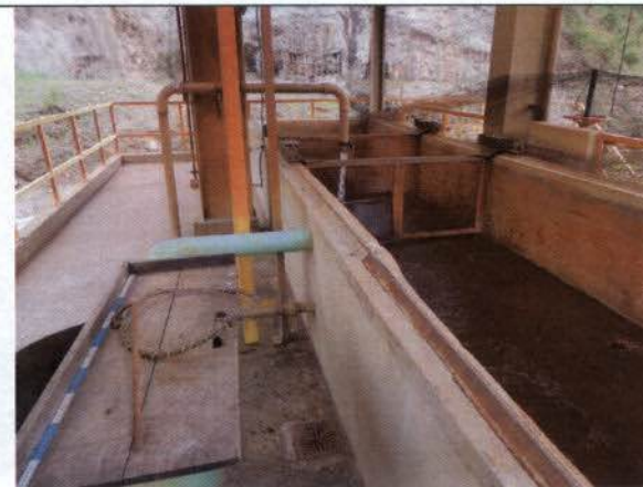
Foto 06: Área de triagem, com tanque dividido por grades.
