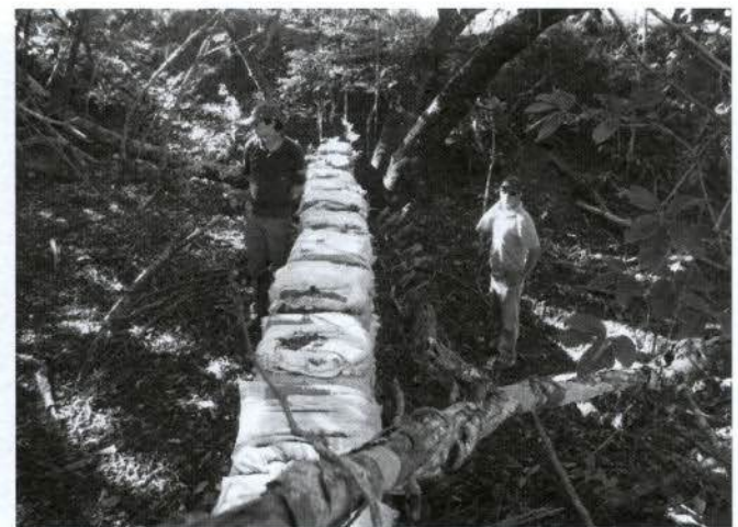
Figura 24: Interior da erosão E 42. Diferença de nível provocada pelo quantitativo de sedimentos retidos pela barreira de paliçada.
