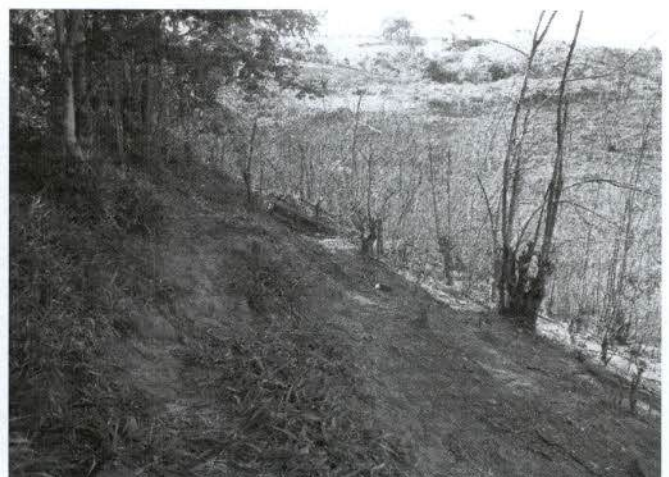
Figura 30: Área abaixo das coordenadas da Erosão E51, mostrando piquete de NA máximo.
