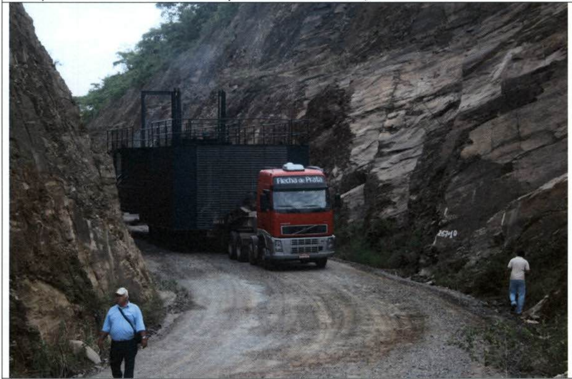
Chegada do Flutuante ao Canteiro de Obras do AHE Serra do Facão
