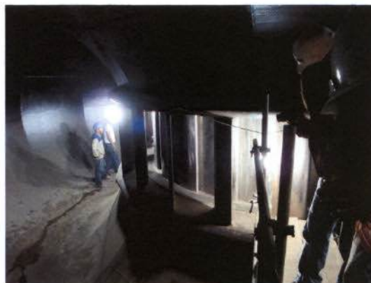
Foto 10: Caracol de uma das unidades geradoras. Detalhe das haletas fixas que direciona a água para mover a turbina e mais ao centro, haletas móveis que se fecham nas paradas de máquina, assim impedindo a subida de peixes.
