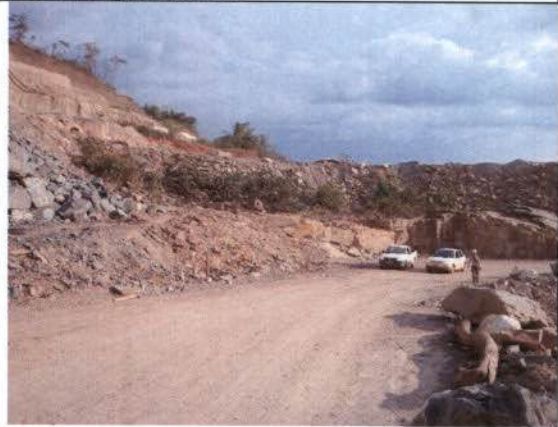
Foto 6 - Local de instalação do Sistema de Transposição de Peixes (rochas atrás dos carros).
