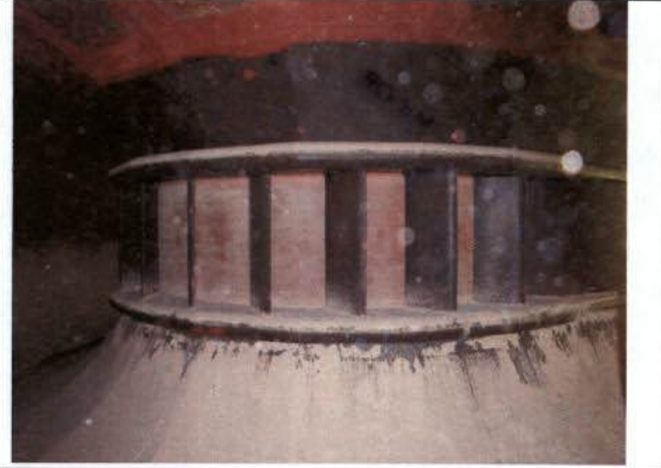
Foto 5 – Caracol da unidade geradora 2.
