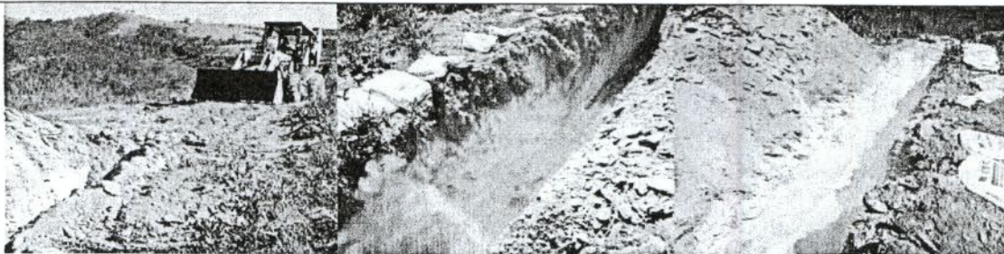
FOTO 23. Imagens das valas destinadas para receber peixes mortos.
