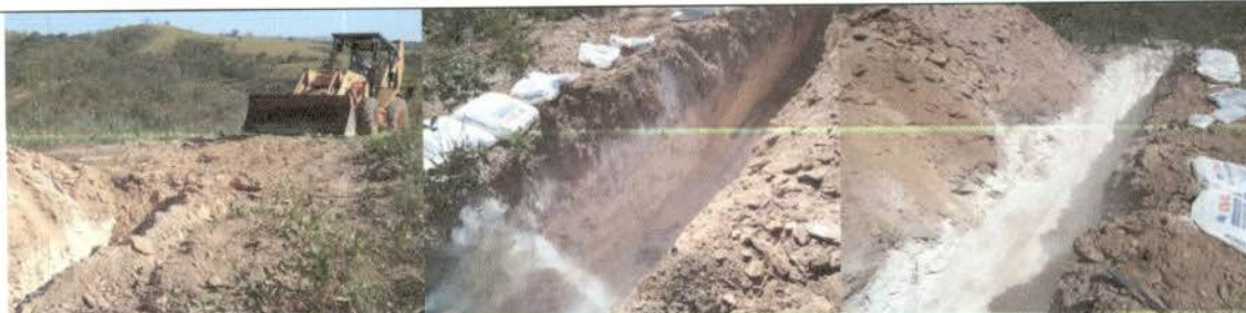
FOTO 23. Imagens das valas destinadas para receber peixes mortos.
